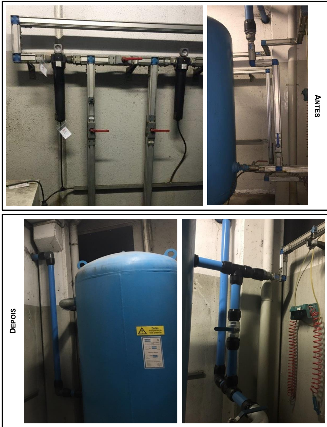
Figura 7.2 – Fotografias da rede de ar comprimido antes e depois da intervenção.
