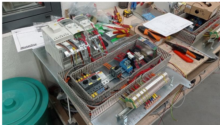
Figura 31 - Eletrificação de platine do quadro elétrico
