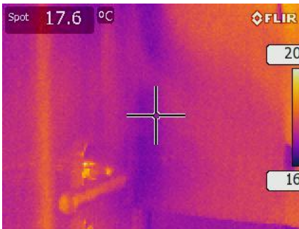
Figura 3.52 – Vista termográfica da porta de acesso à varanda
