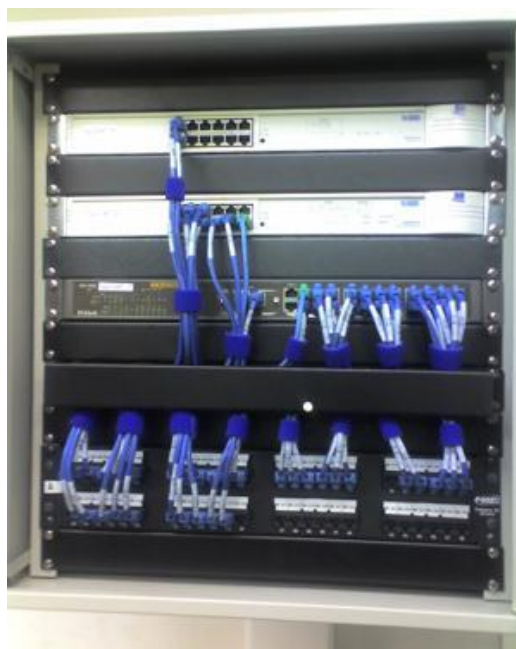
Figura 2 – Bastidor Informático ( Rack com patch-panels e patch-cords ) (Fonte: Próprio autor)
