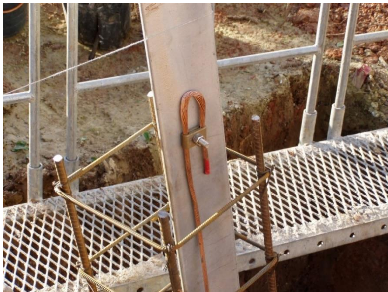
Figura 6 – Ligação do apoio à malha de terra (fonte: REN).
