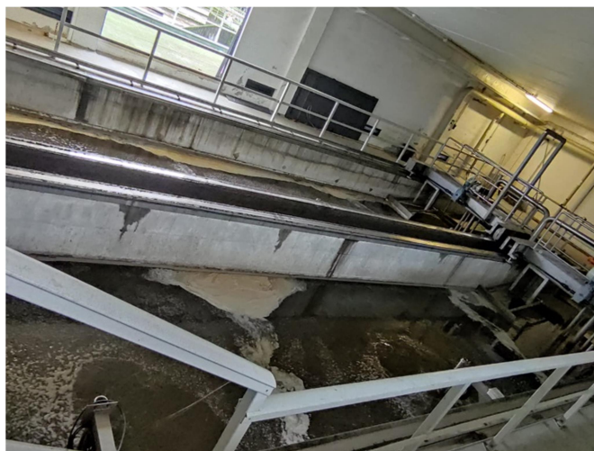
Figura 3.3: Órgãos de desarenamento e desengorduramento.
