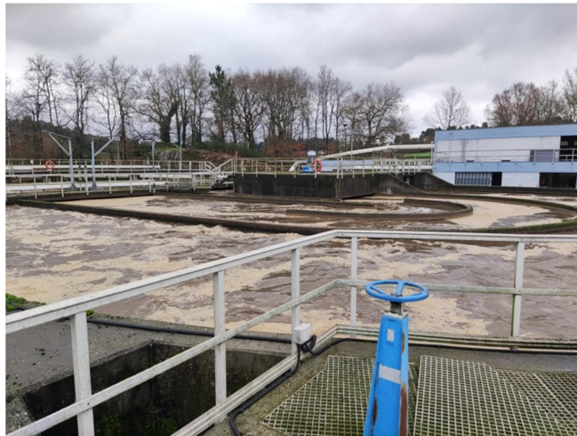
Figura 3.4: Reator biológico (valas de oxidação).
