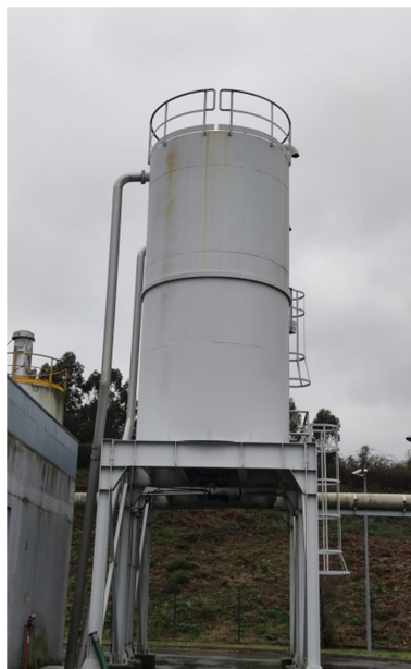
Figura 4.7: Silo de armazenamento de lamas.
