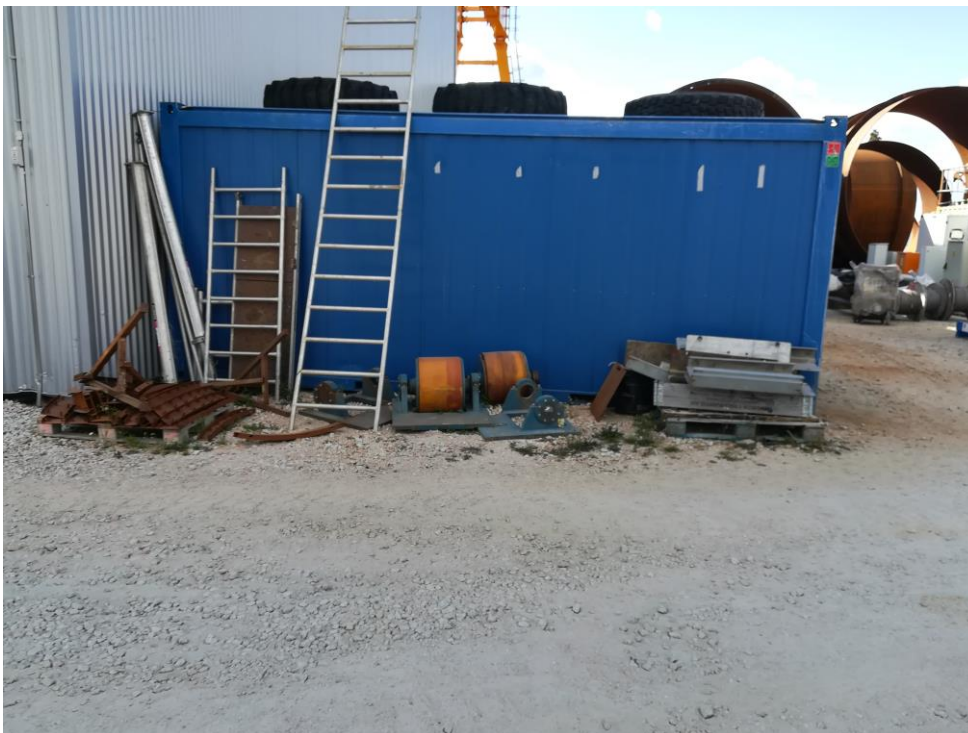
Figura 38 - Desarrumação das frentes de trabalho
