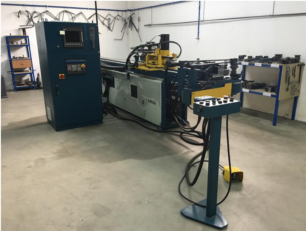
Figura 39 - Aspeto geral da zona da CNC depois das melhorias
