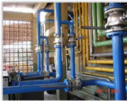
Figura 60 - Ligações flangeadas entre tubos e válvulas
