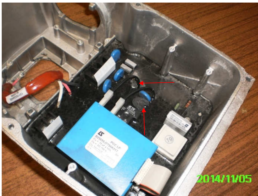
Figura 151 - Variador de frequência avariado de compressor IRN11-8 (Fonte: Ingersoll-Rand )
