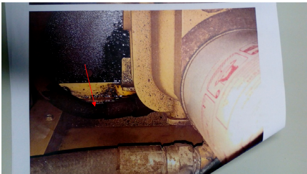
Figura 157 - Fuga de óleo pela mangueira de descarga (Fonte: Ingersoll-Rand)
