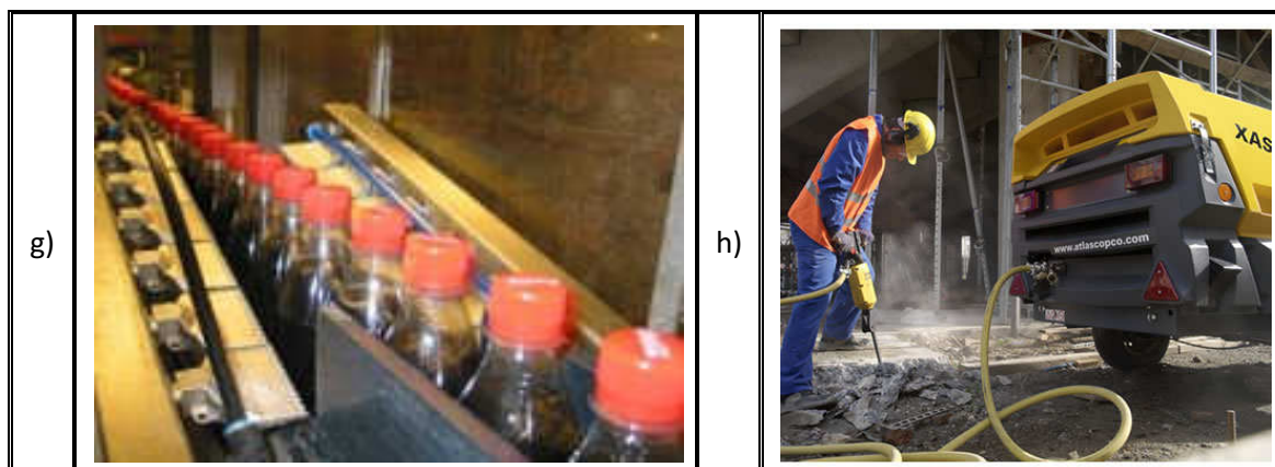
Figura 5 - g) Indústria das bebidas e, h) construção civil (Fonte: Silvant e Atlas Copco)
