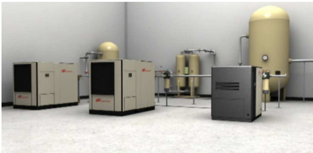
Figura 8 - Central de ar comprimido (Fonte: Ingersoll-Rand ).
