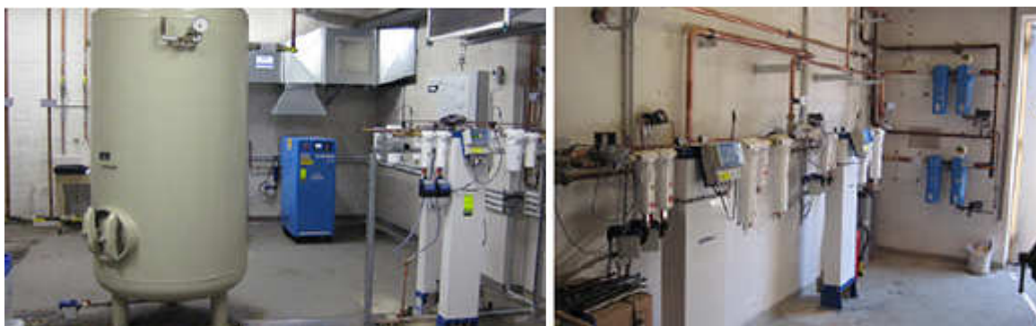
Figura 6 – Equipamentos de ar comprimido medicinal (Fonte: Biomicro).
