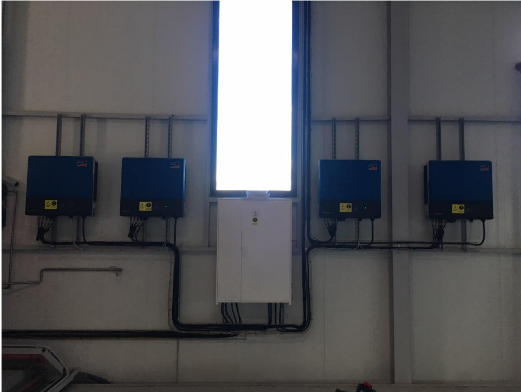
Figura 7.9: Quadro de produção e inversores com sinalização e numeração adequada
