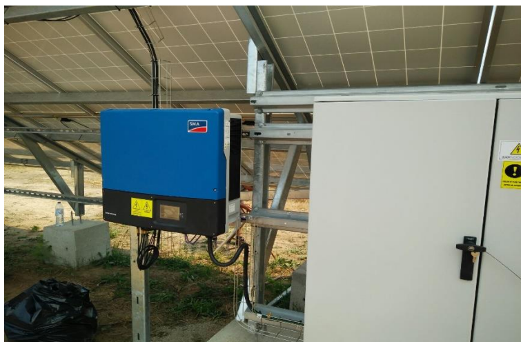
Figura 7.23: Posicionamento do quadro de produção junto a um dos 5 inversores
