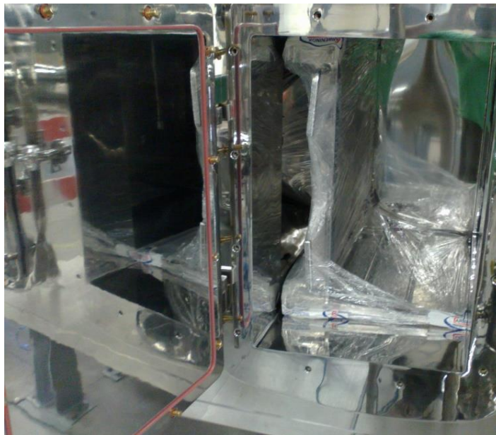
Figura 24 Vedação do Hepa filter atual
