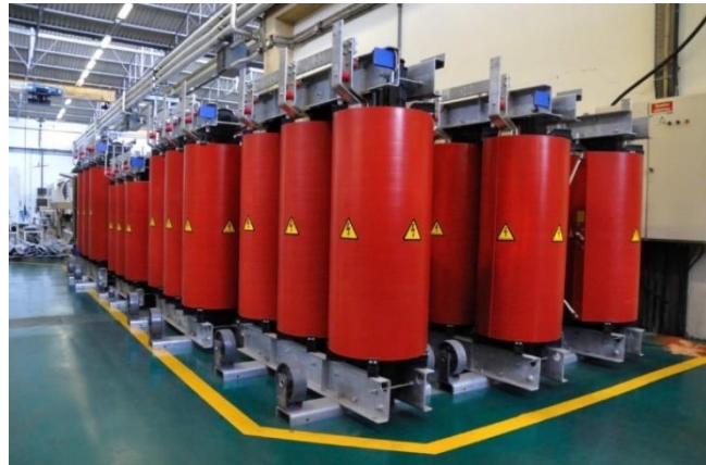
Transformadores de Distribuição (DT) do tipo PowerCast (Secos)
