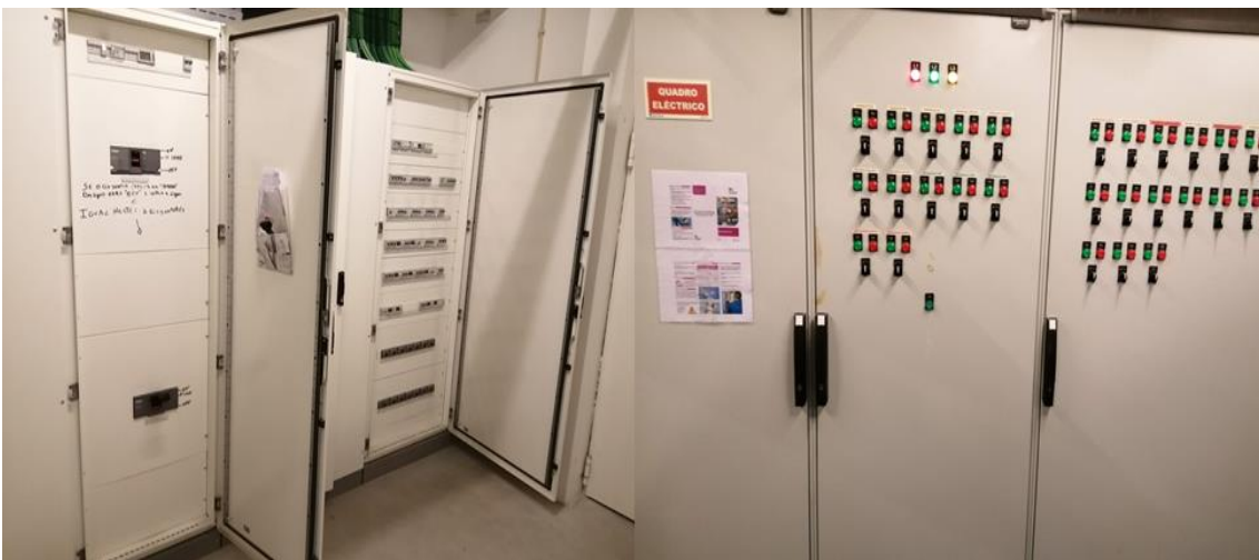
Figura 7 – Zona técnica Quadros elétricos.
