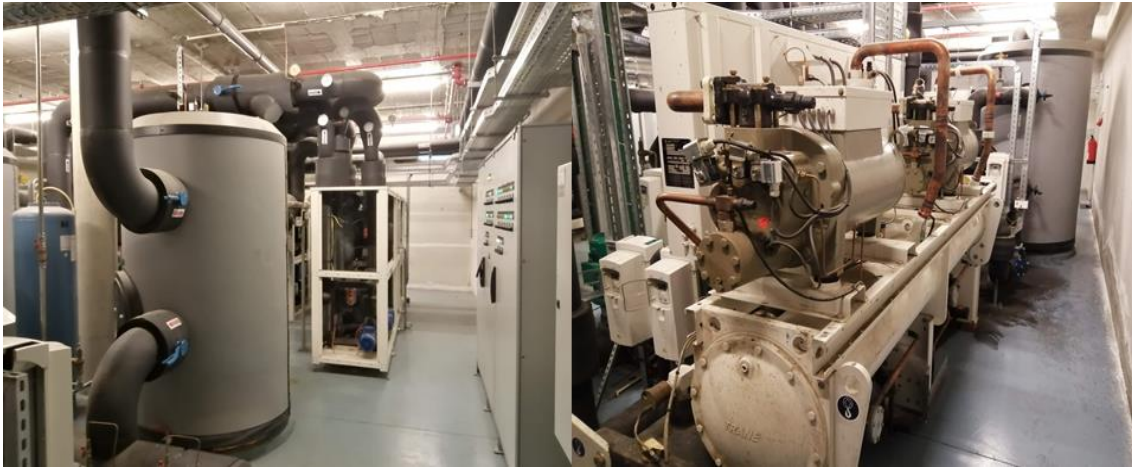
Figura 6 – Zona técnica Chiller's.
