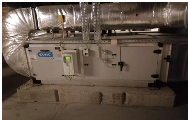
Figura 26 – Unidade de tratamento de ar.
