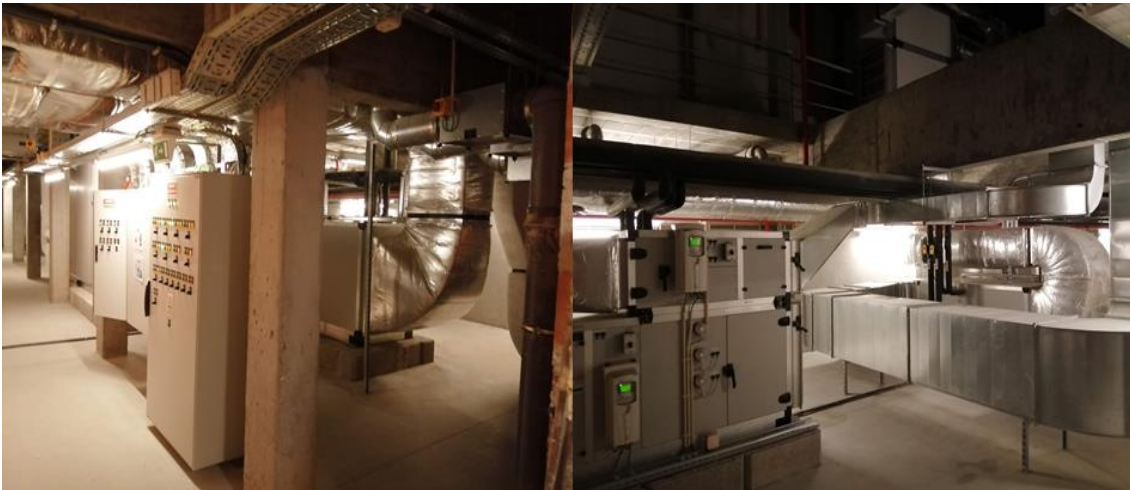
Figura 9 – Zona técnica piso 3.
