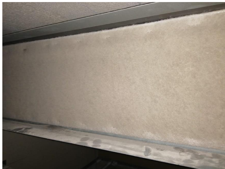
Figura 22 – Filtro do ventiloconvetor de um quarto.
