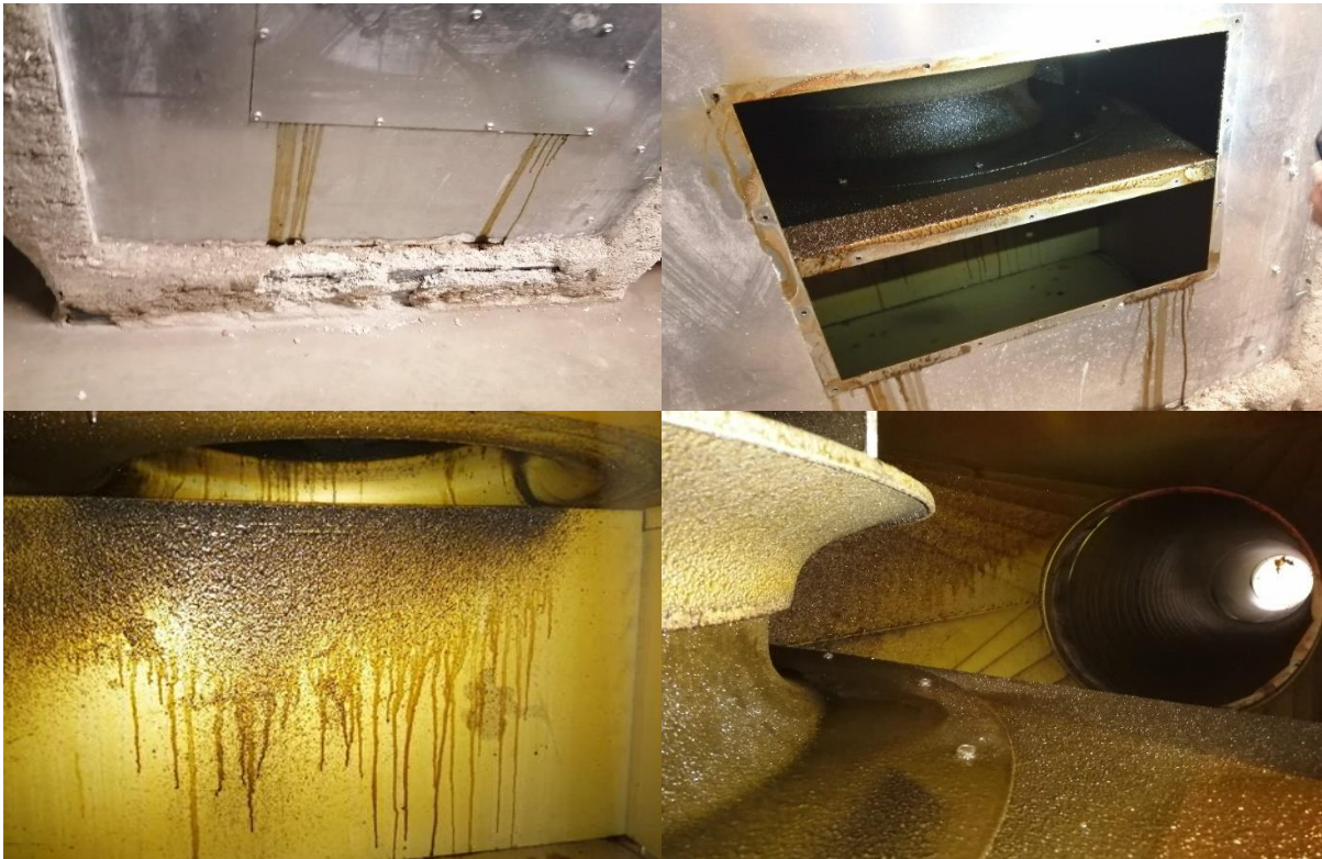
Figura 19 – Ventilador extração Hotte's.
