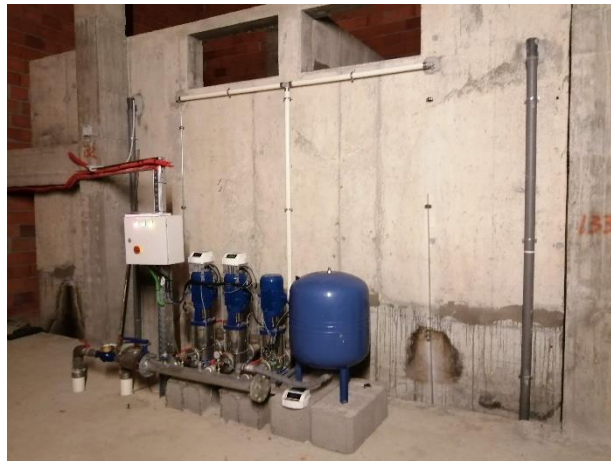
Figura 11 – Zona técnica de água de consumo.
