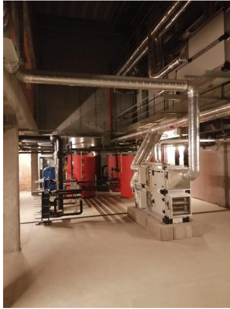
Figura 10 – Zona técnica piso 5.
