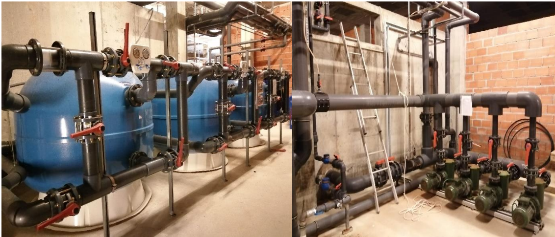
Figura 12 – Zona técnica das piscinas.
