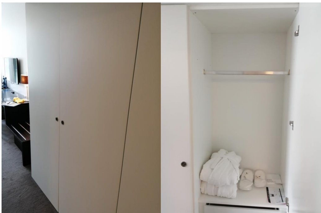
Figura 23 – Acessos ao ventiloconvetor num quarto
