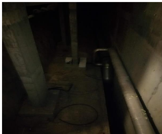
Figura 18 – Conduto sem janelas de visita.
