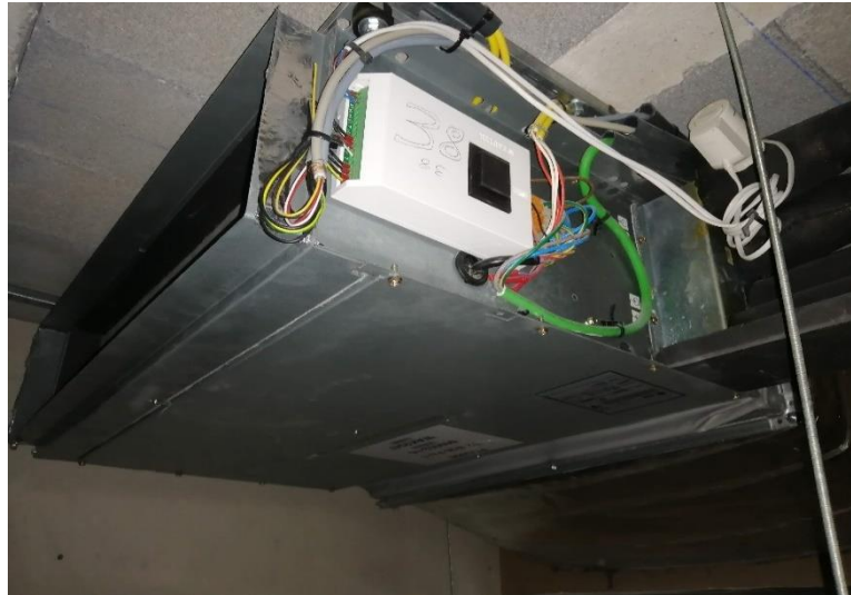
Figura 21 – Ventiloconvetor de um quarto.
