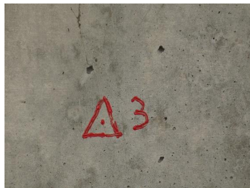
b) Ponto pintado na estrutura
