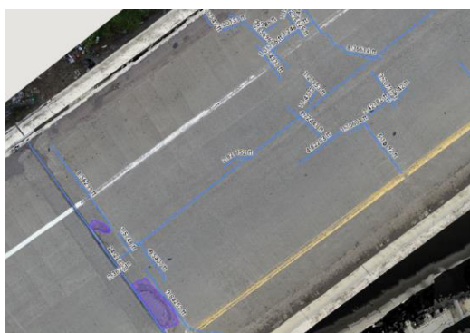
a) Medição de fendas
