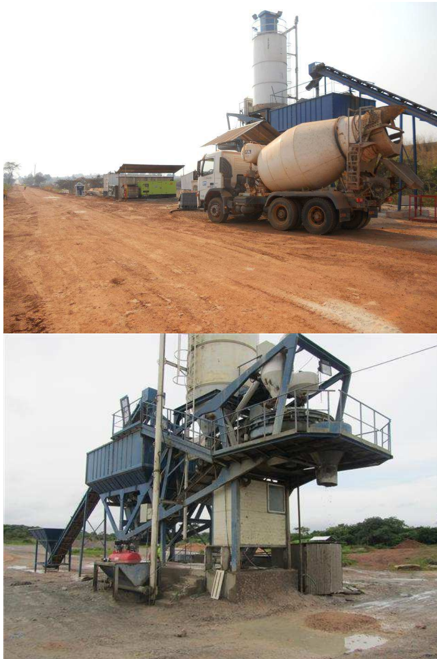
Figura 3.5 – Central de Betão
