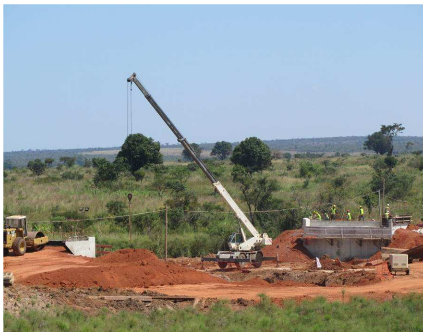
Figura 7.8 – Vista do Encontro E2 e E1, Auto Grua início de execução Pilar P2.
