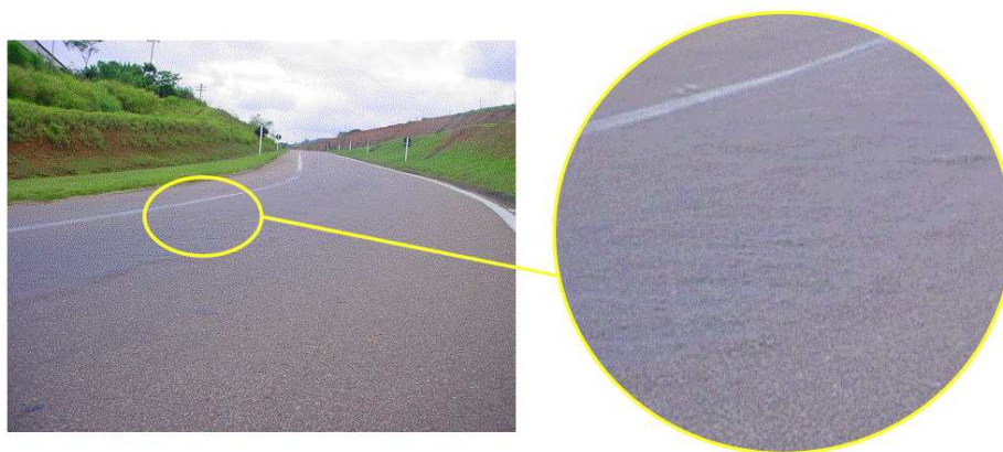
Figura 41- Ondulações ou corrugações (DER/SP, 2006).
