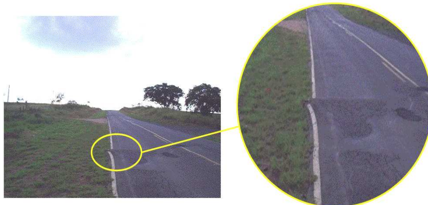
Figura 42 - Escorregamento de massa (DER/SP, 2006).
