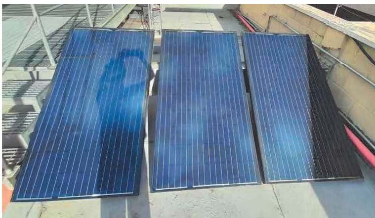
Figura 7 Fotografia da disposição dos módulos fotovoltaicos no local da realização do trabalho.
