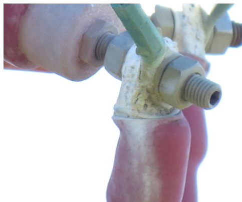
(b) Corrosão galvânica [4]
