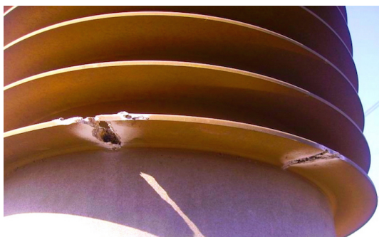
(a) Quebra nos isoladores [3]
