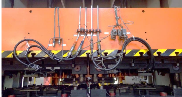
Figura 29 - Cabos da Prensa de Corte
