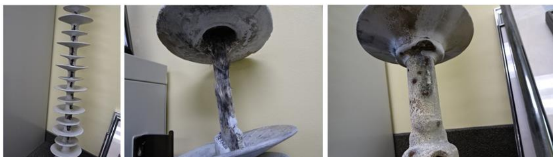
Figura 49 – Danos provocados em isoladores compósitos pelo efeito coroa [66]
