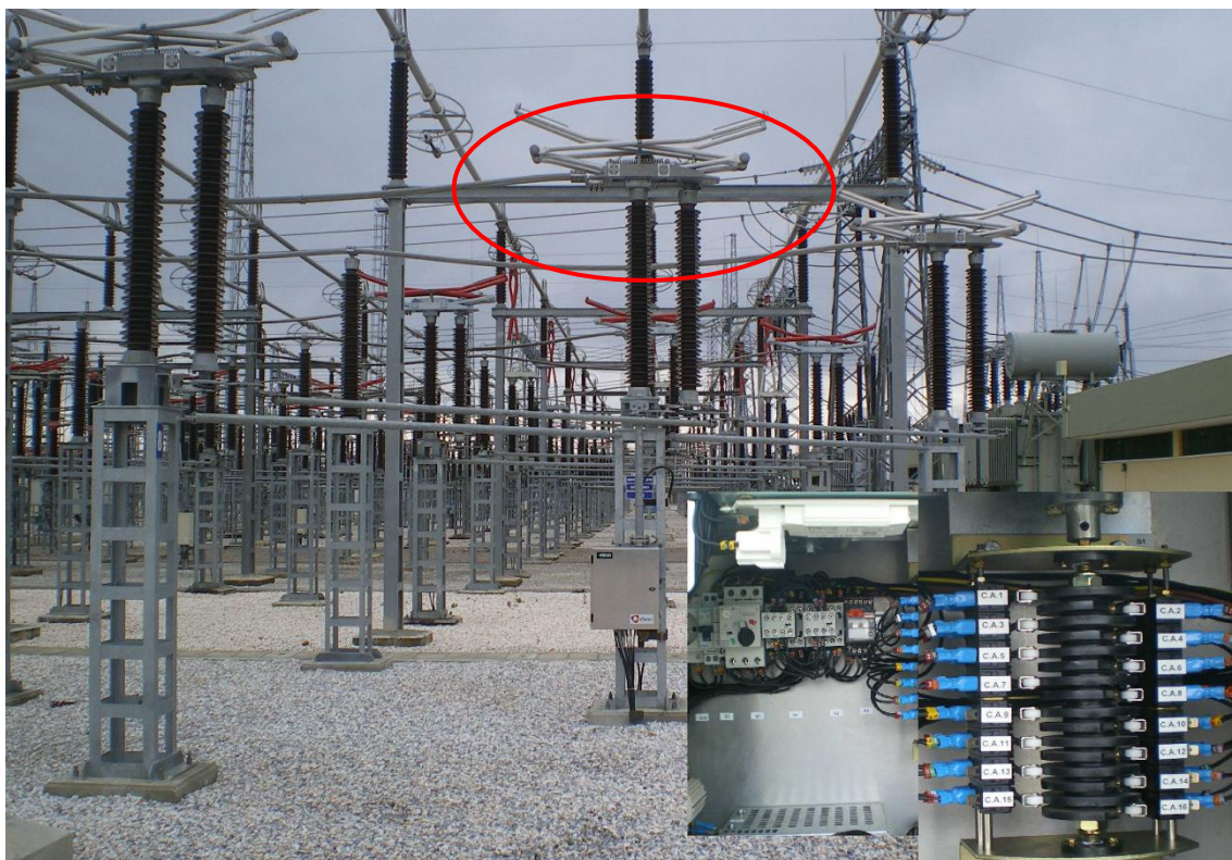
Figura 20 – Seccionador do barramento [14]
