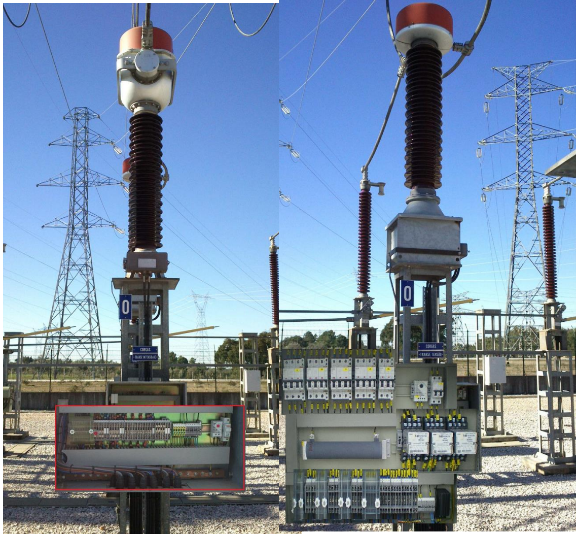
Figura 21 – Transformador de corrente (esquerda) e transformador de tensão (direita) [14]
