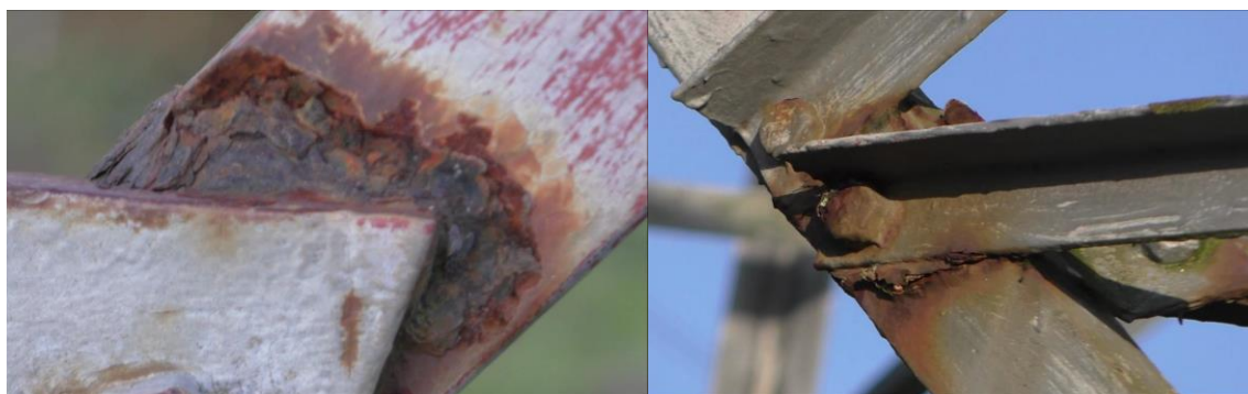
Figura 73 – Pormenores de uma inspeção de corrosão (fonte: REN)
