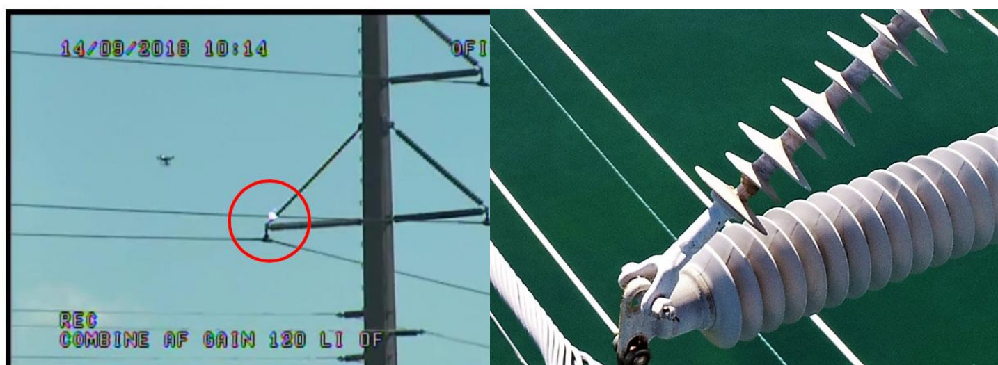
Figura 50 – Ponto quente detetado (em cima) e confirmação do defeito recorrendo a um UAV [66]
