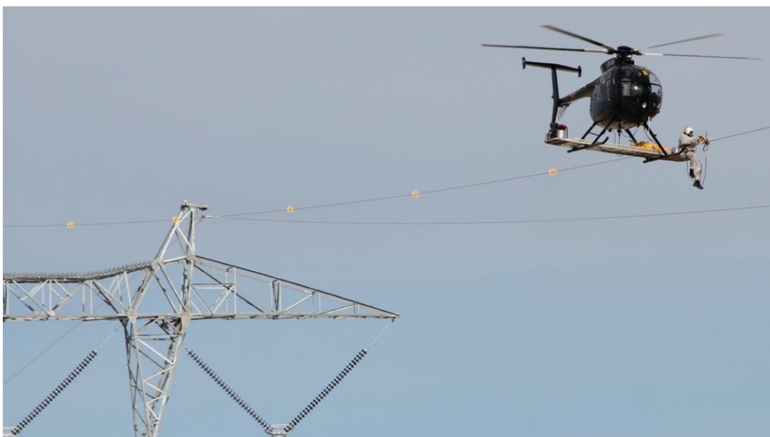
Figura 84 – Riscos humanos e infraestruturais dos trabalhos das metodologias tradicionais [96]
