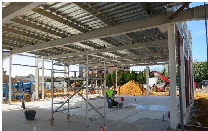
Figura 5.7 - Pórticos presentes num edifício de restauração idêntico, em Santa Maria da Feira
