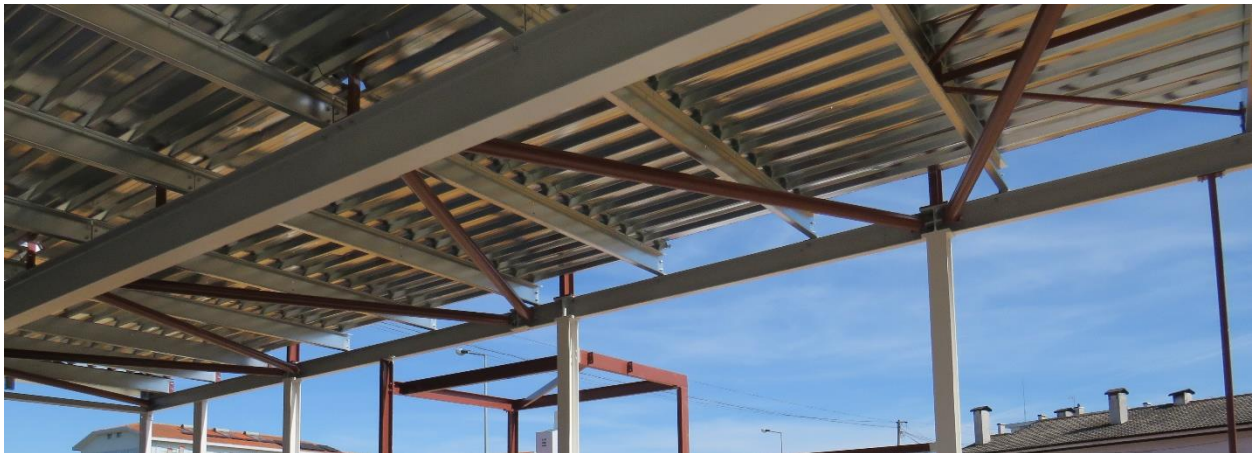
Figura 5.13 - Contraventamento presente numa estrutura de edifício de restauração idêntico ao caso de estudo, em Santa Maria da Feira
