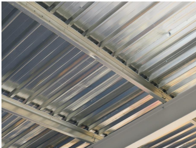
Figura 5.2 - Madre em C, utilizada num edifício de restauração idêntico, em Santa Maria da Feira
