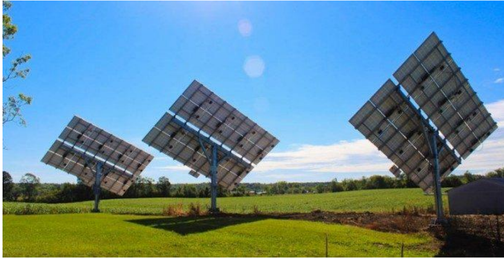
Figura 24 – Painéis fotovoltaicos com sistema de seguimento solar [16].
