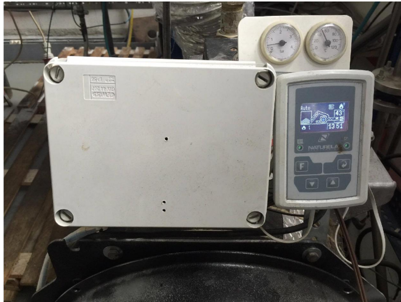
Figura 13 Comando e controlador elétrico da caldeira
