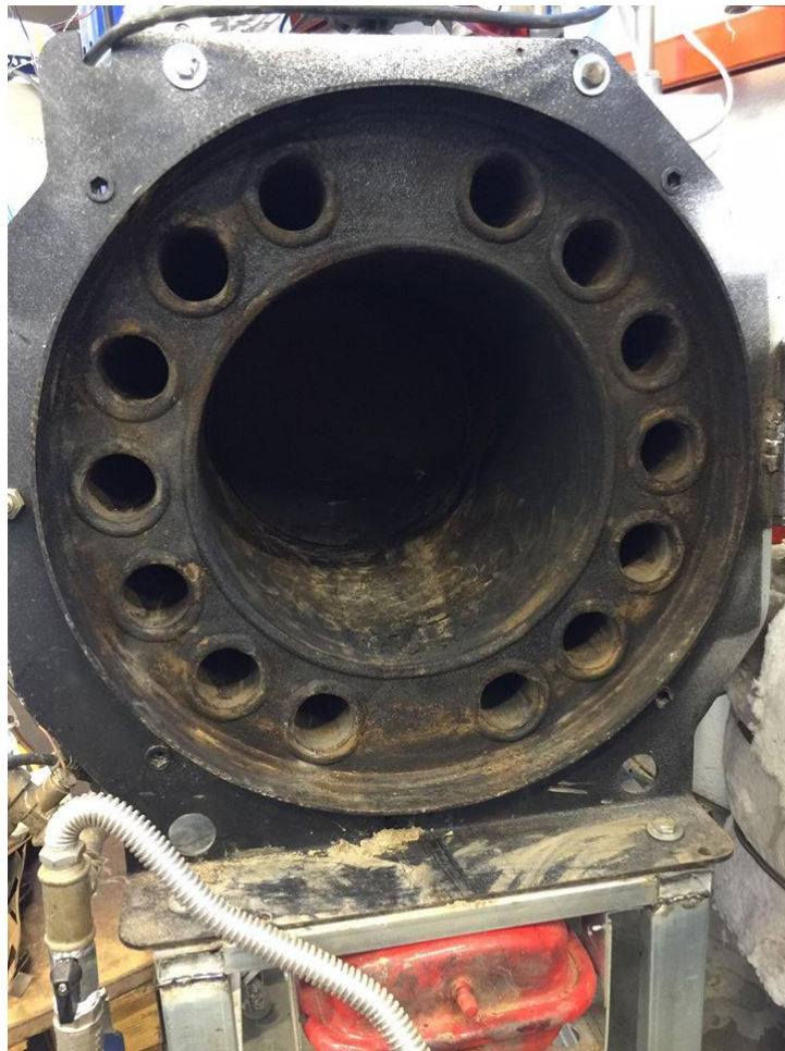
Figura 11 Câmara de combustão e tubos de fumo na caldeira utilizada na instalação.
