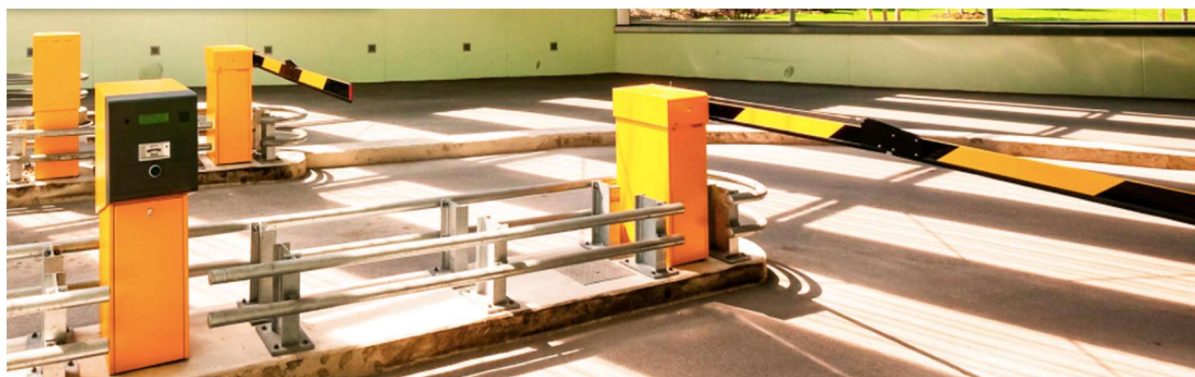
Figura 1 – Barreiras automáticas para controlo de acessos a parques de estacionamento. (fonte: http://www.gestao-parques-estacionamento.pt/gestao-parques-estacionamento-idpark/ )
