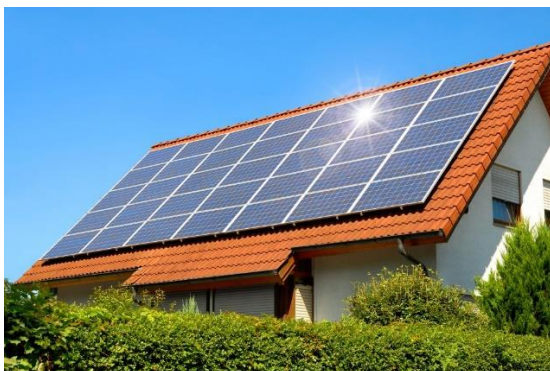
Figura 40 – Aplicação FV em telhado de uma habitação [11]
