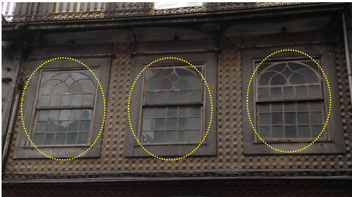
Figura 3.18 - Presença de humidade nas madeiras dos envidraçados
