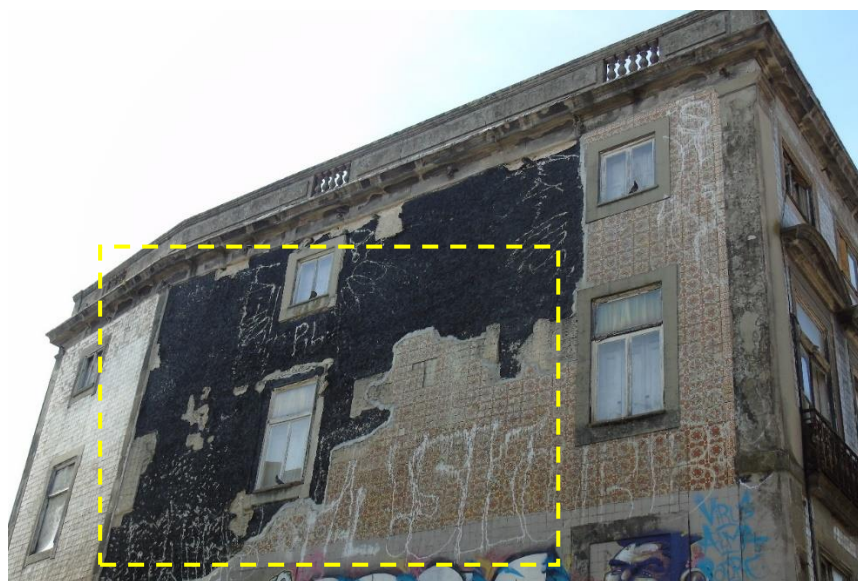
Figura 3.13 - Exemplo de betuminoso exposto, que se aplicava, por vezes (como se observa) com duvidosos resultados, para melhorar a impermeabilização de uma fachada revestida a azulejo.
