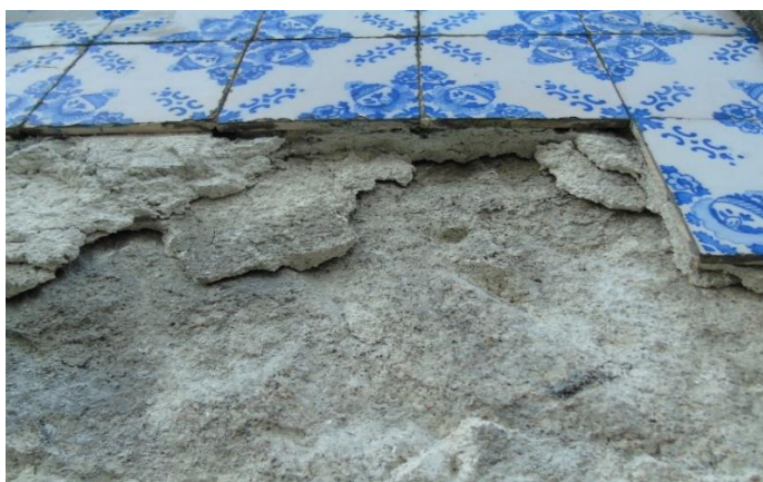
Figura 3.7 - Desagregação das argamassas devido à presença da humidade.
