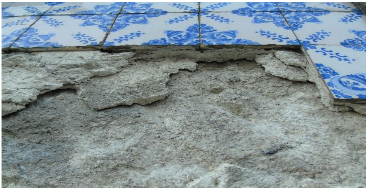
Figura 2.11 - Foto detalhada das argamassas de ligação do azulejo à fachada e consecutiva desagregação da argamassa.
