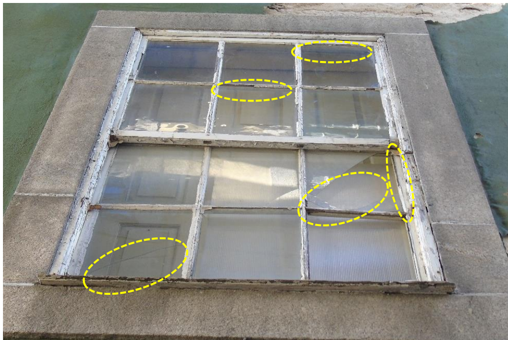
Figura 3.20 - Desgaste visível nas massas de vedação dos vidros na zona dos caixilhos e presença de vidros partidos.
