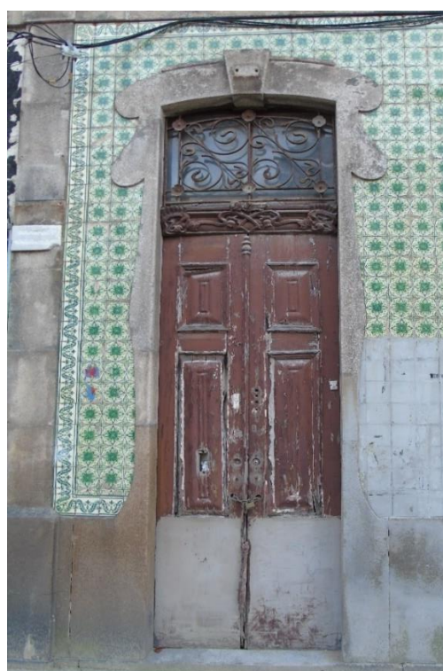
Figura 2.15 – Porta em mau estado de conservação, encimada com bandeira em vidro com almofadas de madeira.
