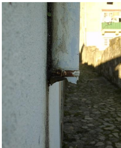
Figura 3.25 - Tubo em plástico partido e com fixação oxidada.
