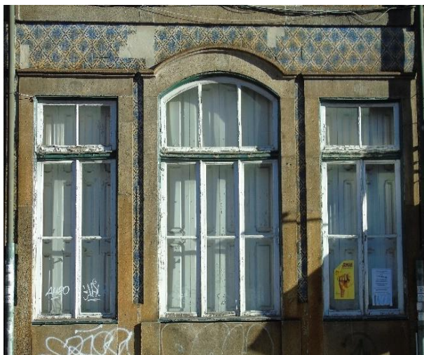
Figura 4.8 - Cantaria com eflorescências
