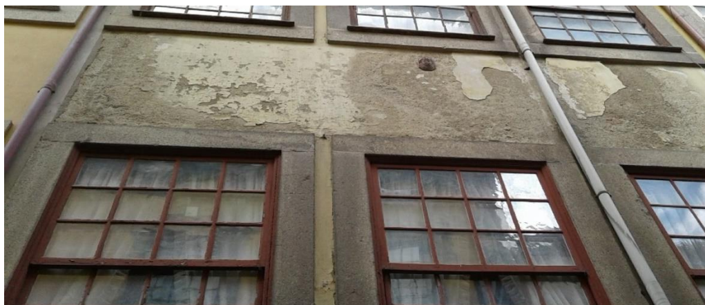
Figura 5.34 – Destacamento da argamassa de reboco.
