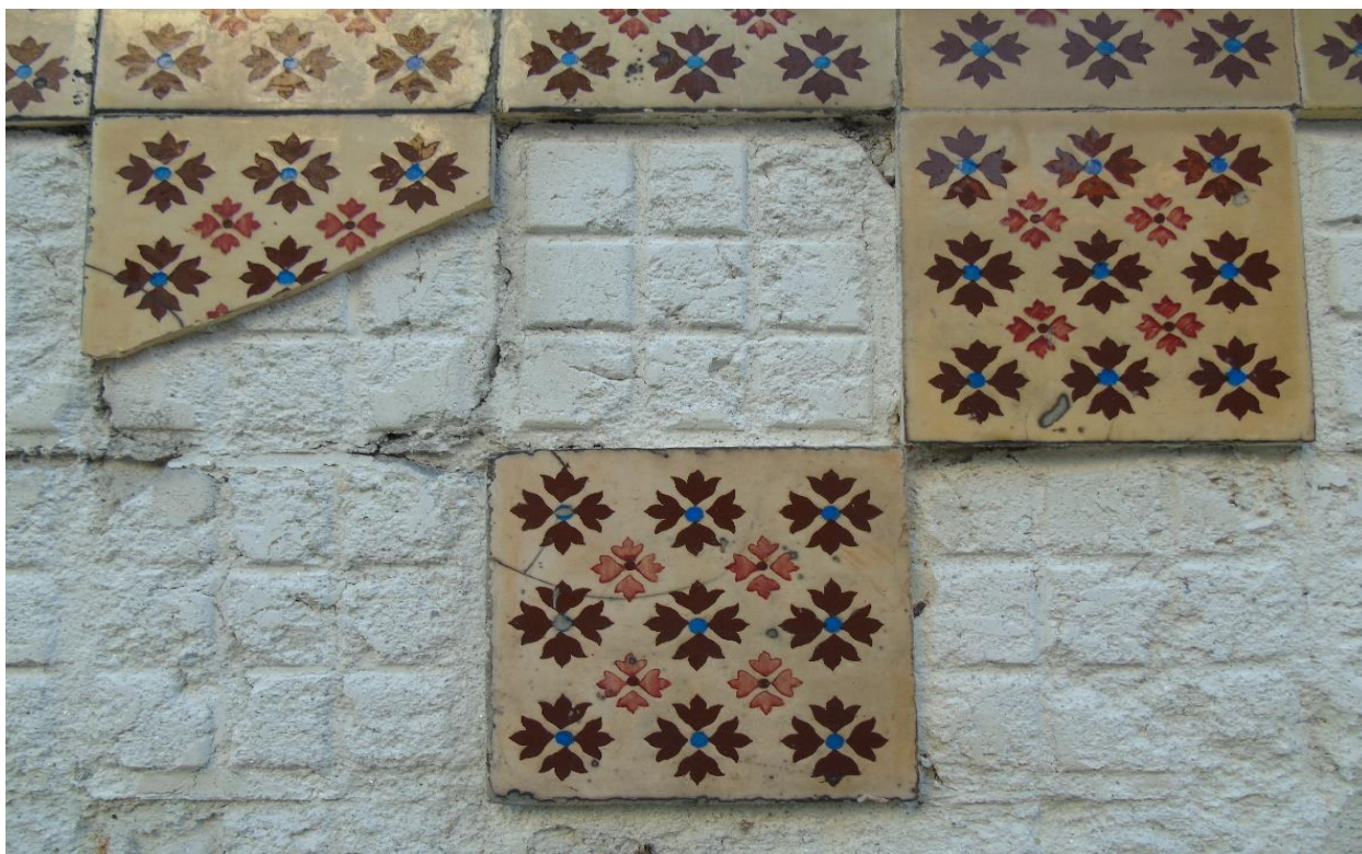
Figura 2.10 - Descolamento dos azulejos da parede.
