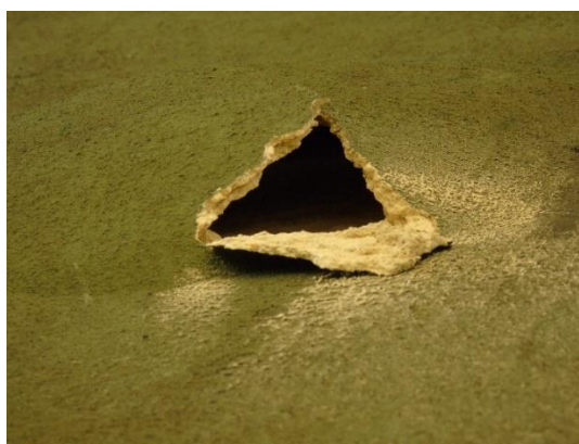
Figura 3.16 - Abertura na argamassa de revestimento que possibilita a penetração de água e consequente empolamento do reboco.
