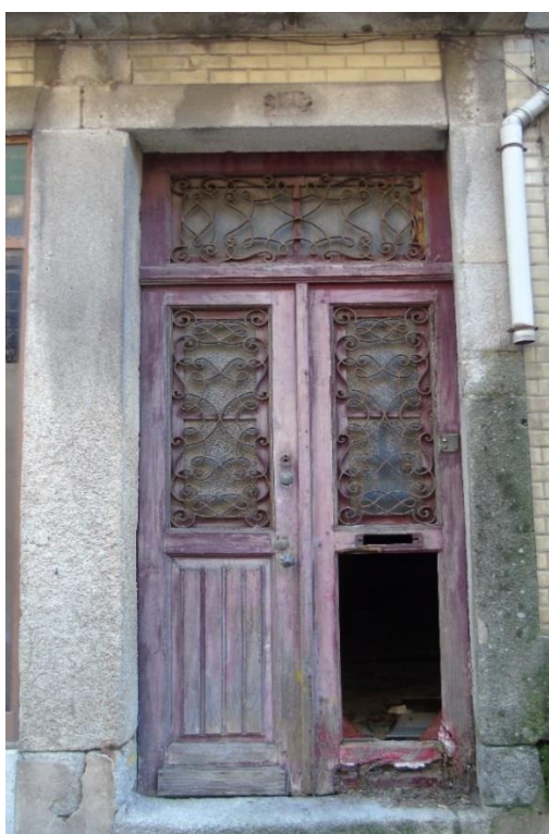
Figura 2.14 - Porta em mau estado de conservação, encimada com bandeira em vidro e vidros na zona das folhas da porta.
