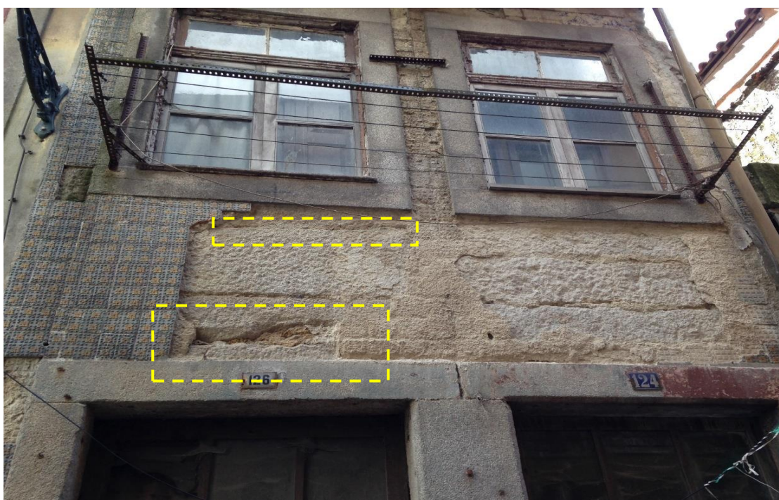
Figura 3.6 - Presença de fissuras junto da zona envolvente entre envidraçados / portas.
