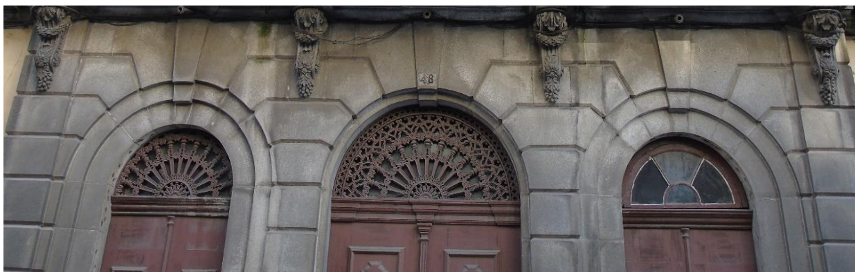
Figura 4.19 - Portas exteriores de entradas encimadas por bandeira com gradeamento de ferro fundido (note-se a anomalia da porta direita, sem esse elemento metálico).
