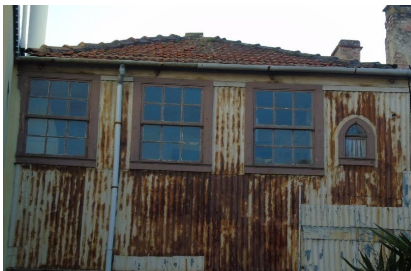
Figura 3.2 - Oxidação das chapas de revestimento da fachada de tardoz.
