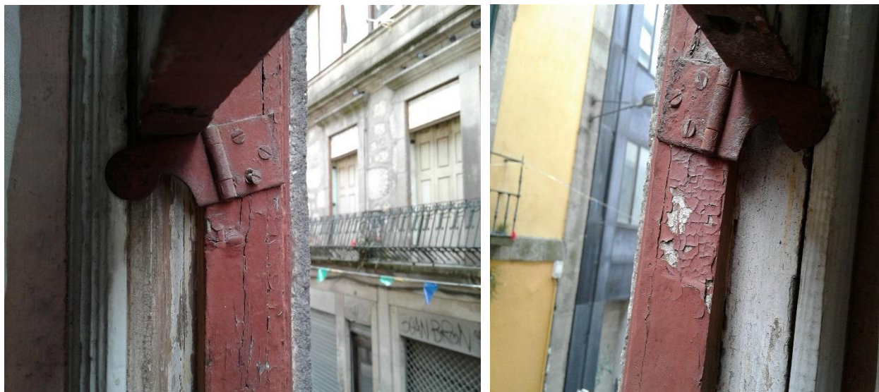
Figura 5.41 – Suportes da zona superior do envidraçado degradados.
