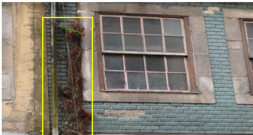
Figura 3.1 - Ocorrência de uma ação biológica em fachada, provocando separação da união entre os azulejos e as cantarias em torno da janela de guilhotina.
