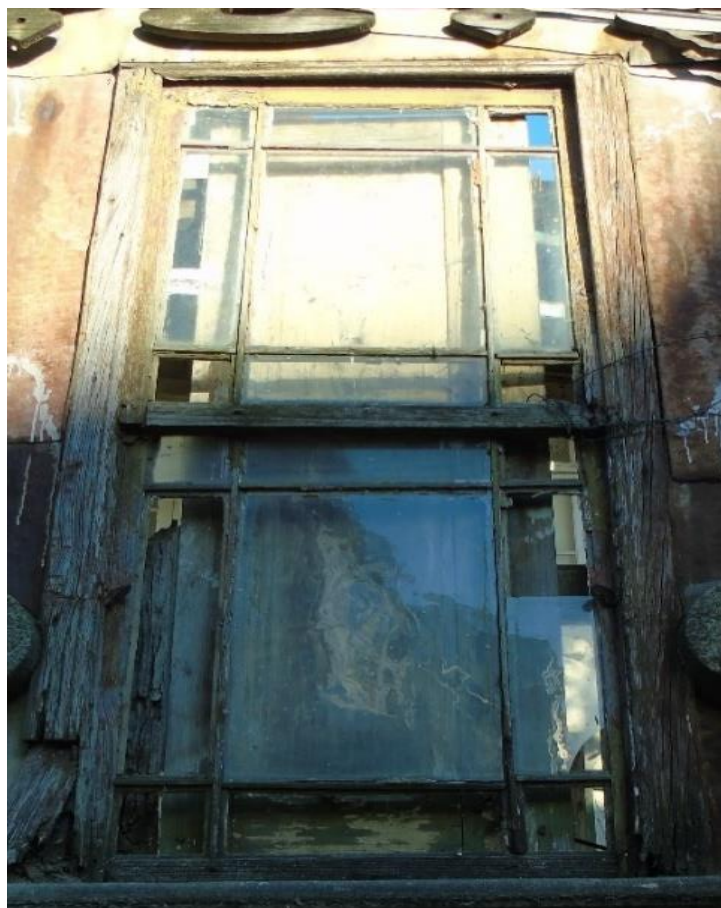
Figura 3.19 - Descamação da pintura devido à presença de humidade.
