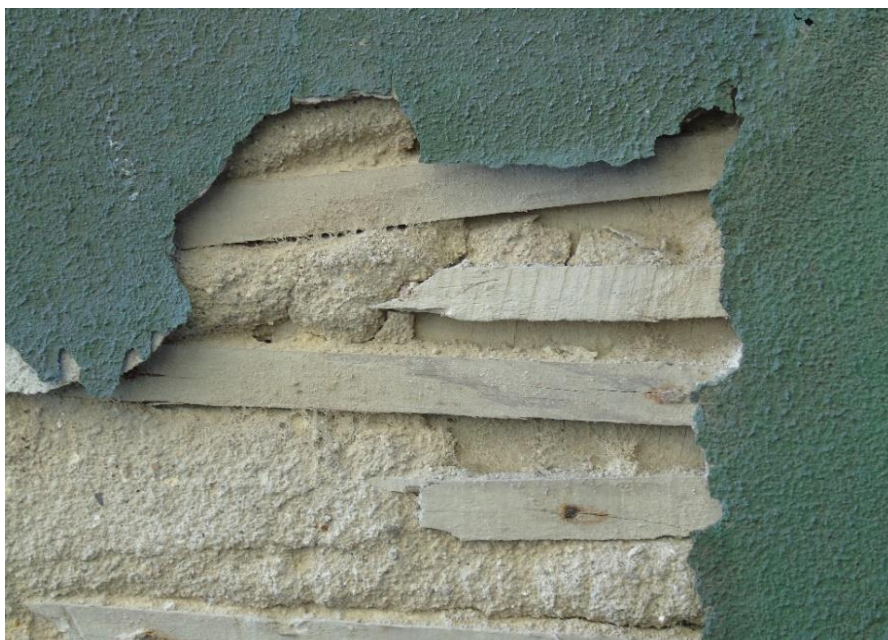
Figura 3.3 - Parede de fachada com o tabique exposto, permitindo infiltrações em grande escala para o interior.
