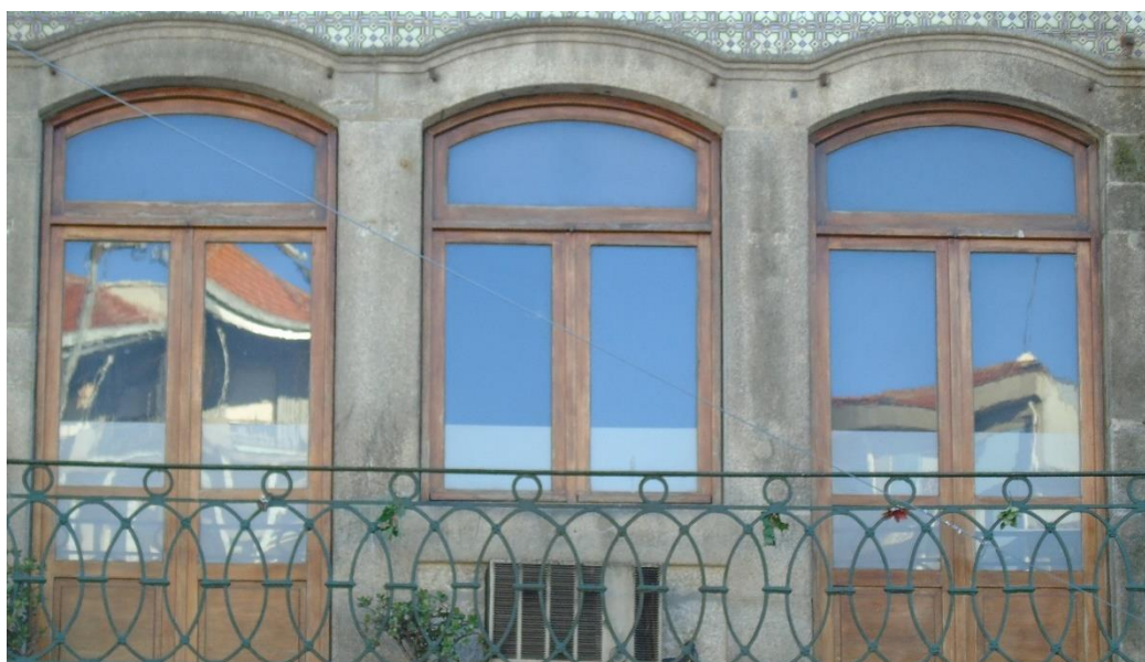
Figura 4.14 - Envidraçados reabilitados, faltando aplicar a pintura sobre a madeira.
