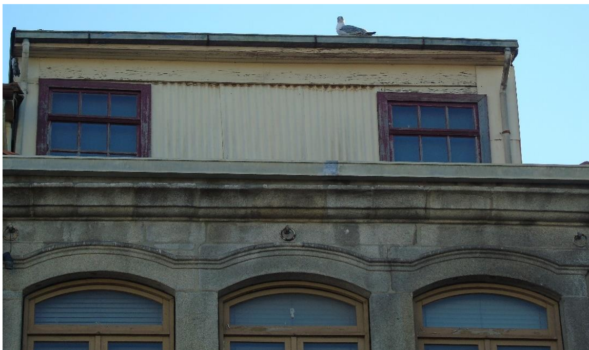
Figura 3.12 - Cornijas com sujidade, manchas e algumas fissurações.
