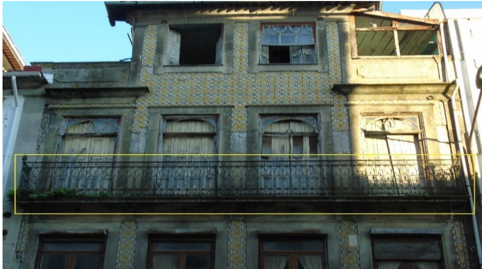
Figura 2.18 - Varanda de sacada em edifício debilitado.
