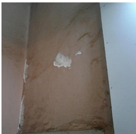
Figura 5.33 – Presença de humidade pelo interior da parede exterior de fachada.
