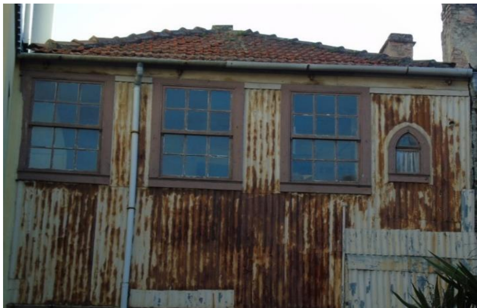
Figura 3.17 - Fachada de tardoiz com bastante oxidação nas chapas de revestimento.
