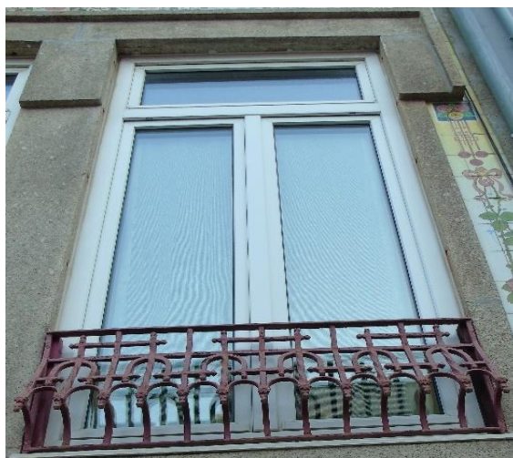
Figura 4.13 - Caixilharia metálica, manifestamente desenquadrada dos elementos circundantes, no que respeita a formato e aspeto.
