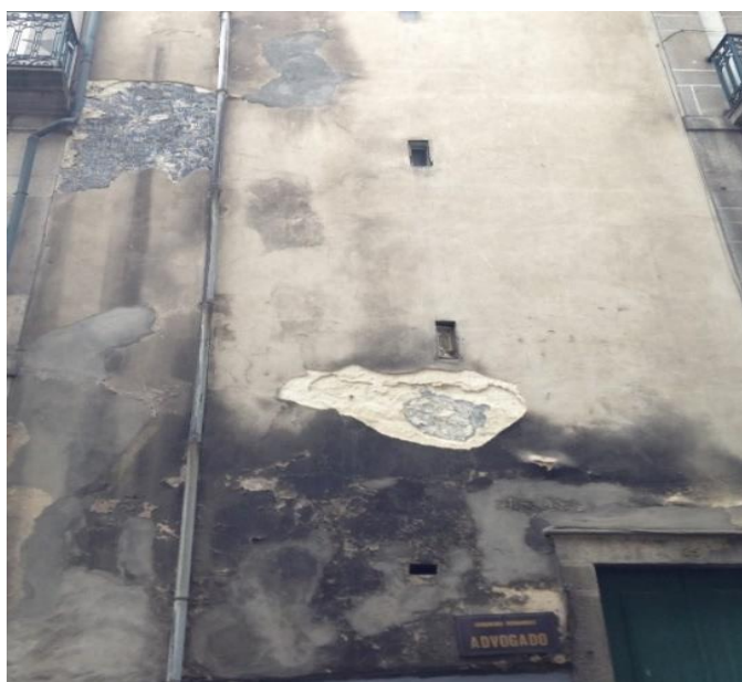
Figura 3.14 - Fachada totalmente degradada devido à presença de humidade proveniente de anomalias na cobertura.
