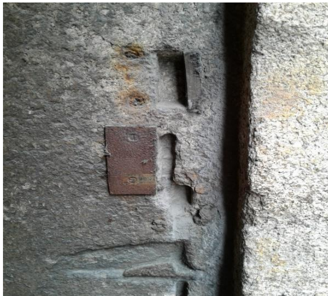
Figura 5.45 – Ferragens onde a porta fica devidamente trancada.
