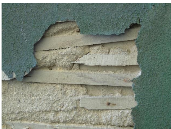
Figura 3.15 - Presença de humidade que causou desagregação da argamassa de revestimento e posterior queda.
