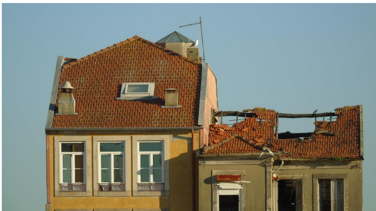
Figura 4.2 - Edifício de cêrcea mais baixa a necessitar de intervenção profunda a nível estrutural e de fachada sem prejudicar os demais edifícios adjacentes.
