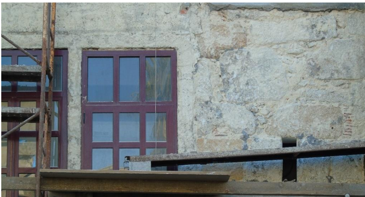
Figura 3.5 - Parede de alvenaria com juntas irregulares, sem argamassa a servir de revestimento.
