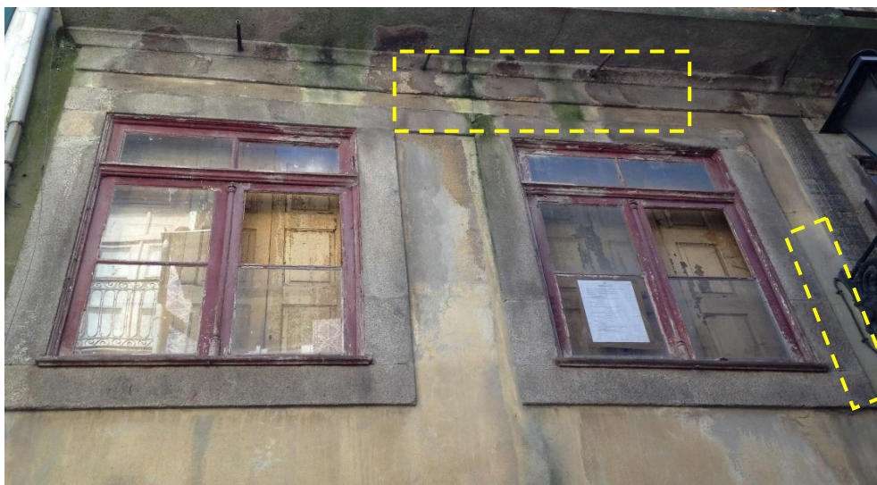
Figura 3.10 - Presença de sujidade e fungos nas peças de cantaria.
