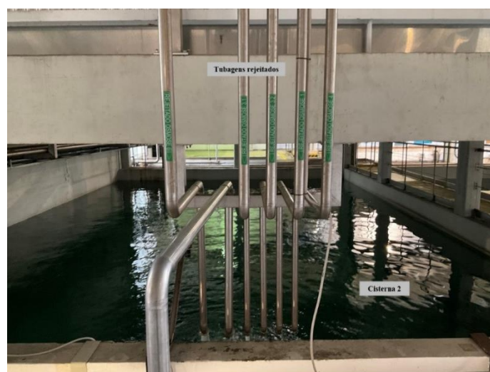
Figura 6. 4 - Fotografia das tubagens de envio dos rejeitados das OI 1, 3.1, 3.2, 4 e 6 para a cisterna 2.
