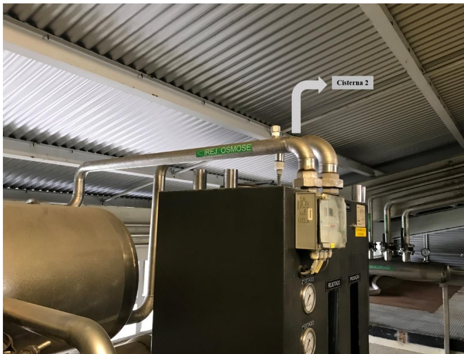
Figura D. 5 - Fotografia da tubagem de rejeitados da OI 2 e respetiva ilustração da alteração sugerida.
