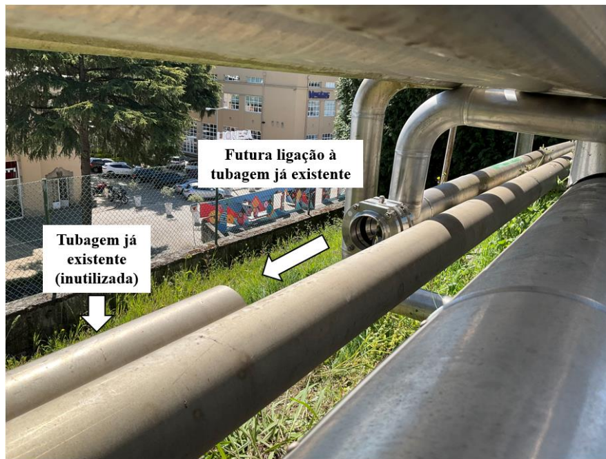
Figura A. 3 - Fotografia da futura ligação que se prevê fazer para permitir o abastecimento de AI à ETAR.
