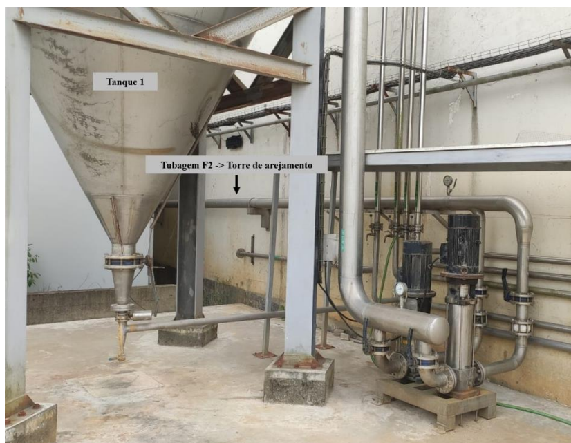
Figura 6. 7 - Tanque 1 e tubagem que direciona a água das captações F2 para a torre de arejamento.
