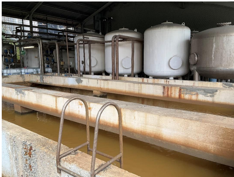
Figura B. 13 - Fotografia da cisterna decantadora da ETA do SBG.
