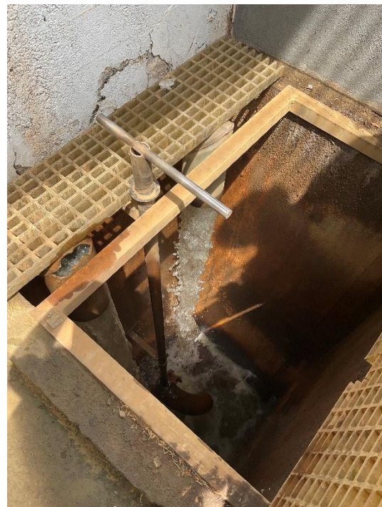
Figura B. 14 - Fotografia da cisterna decantadora a transbordar para esgoto por falta de capacidade.
