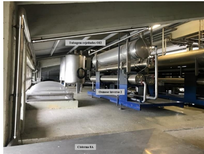
Figura 6. 3 - Fotografia da osmose inversa 2 e respetiva tubagem de envio dos rejeitados para a cisterna 8A.
