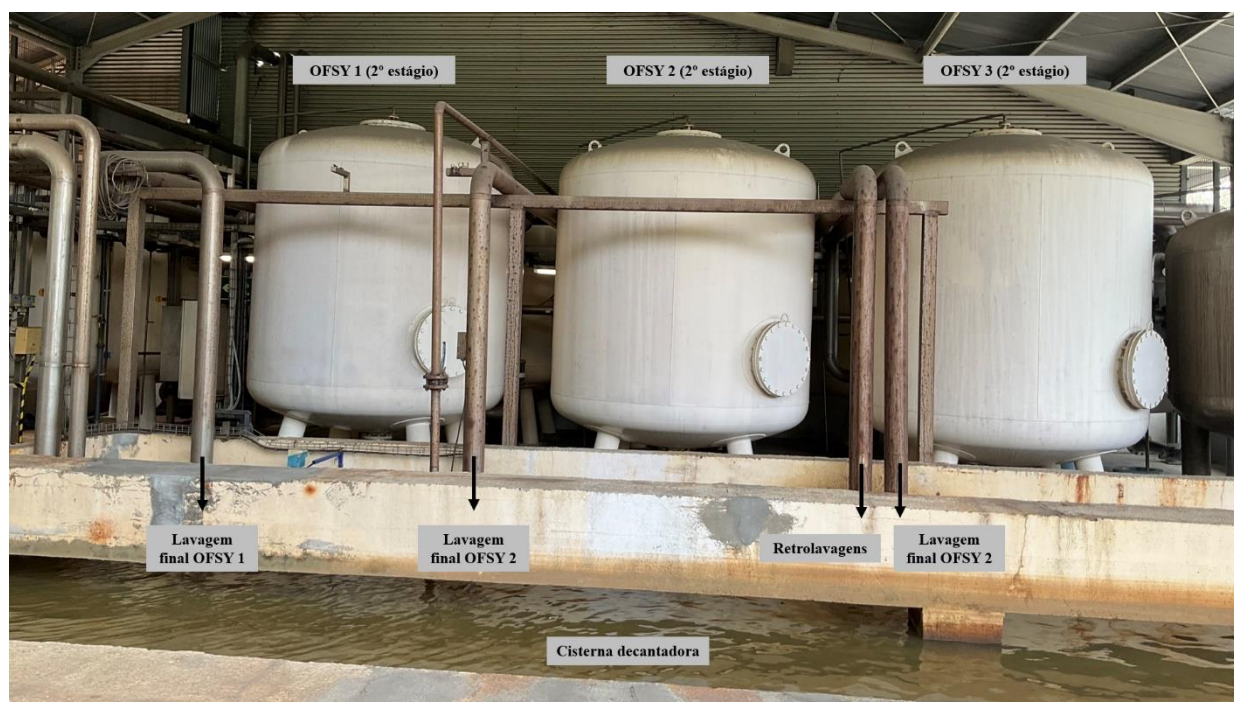
Figura 6. 1 - Fotografia dos OFSYs 1, 2 e 3 e respetivas tubagens que direcionam as lavagens para a cisterna decantadora.
