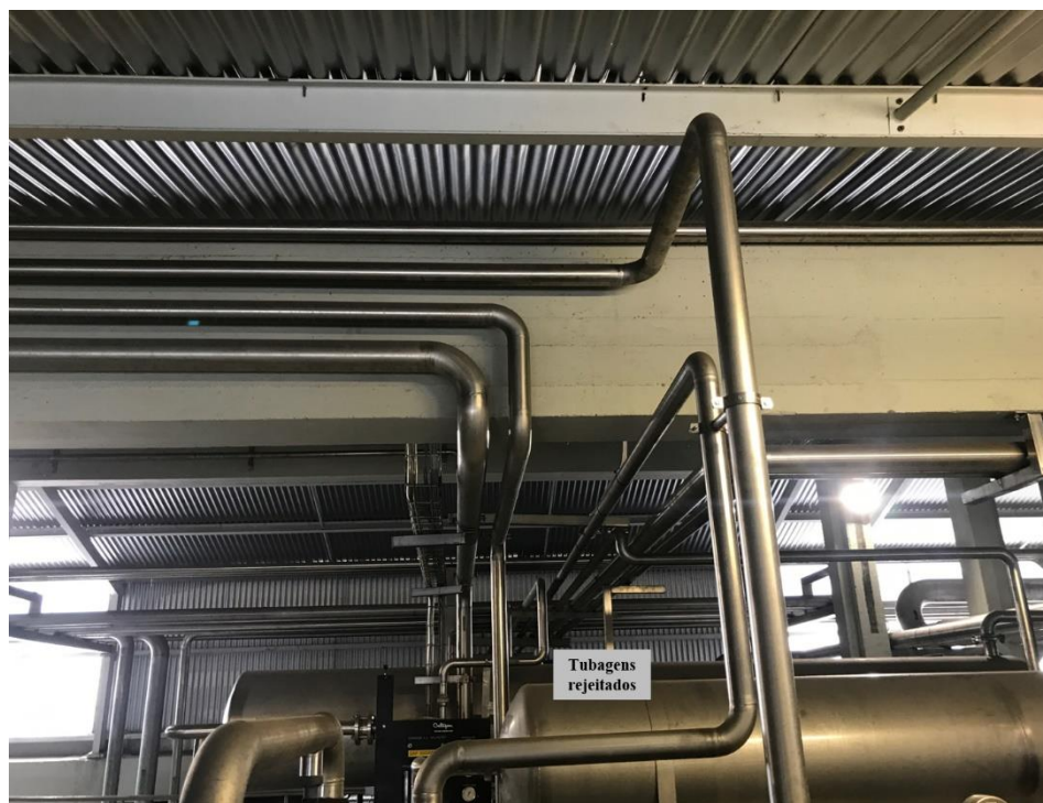
Figura D. 7 - Fotografia da disposição das tubagens dos rejeitados das OI 1, 3.1, 3.2, 4 e 6.
