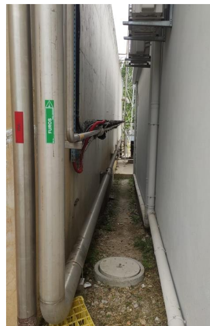
Figura 6. 6 - Local de instalação do novo contador: tubagem que direciona a água das captações F2 para a torre de arejamento.
