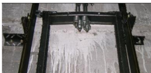
Figura 23 - Empeno da estrutura do contrapeso (Adaptado - [22])
