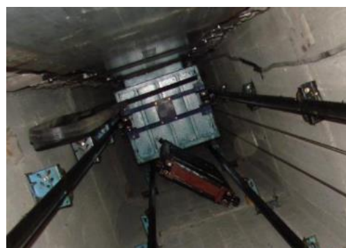
Figura 22 - Descarrilamento do contrapeso e colisão com cabina (Adaptado - [22])
