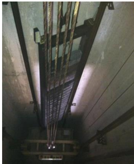
Figura 20 - Descarrilamento do contrapeso e colisão com cabina (Adaptado - [22])
