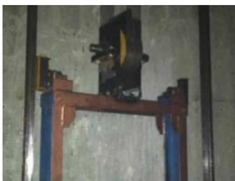
Figura 21 – Dano nas roçadeiras do contrapeso (Adaptado - [22])
