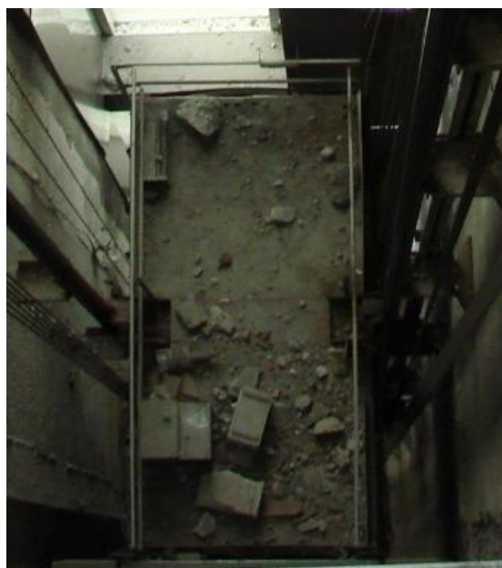
Figura 28 - Queda de blocos em cima da cabina (Adaptado - [22])
