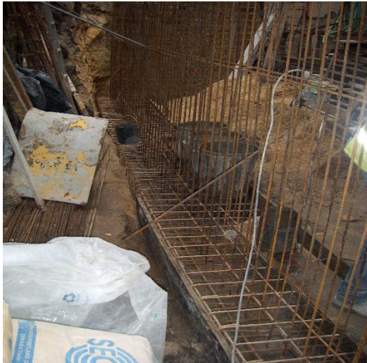
Figura 78 - Execução da parede de separação entre o espaço comercial e o corredor de acesso às habitações
