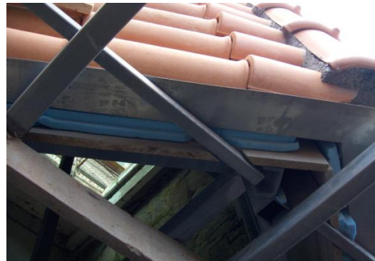
Figura 70 - Pormenor das placas de XPS
