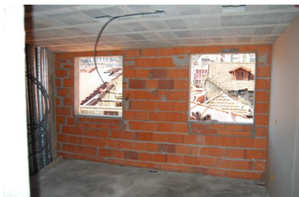
Figura 110 - Estado atual da parede exterior Pe2
