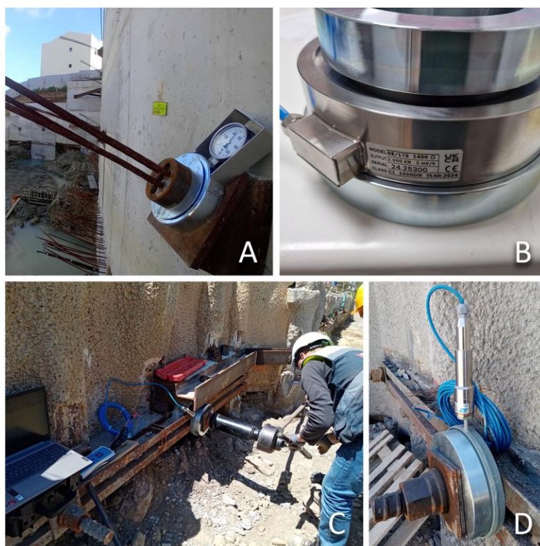
Figura 9 – (A) Célula de carga hidráulica com manómetro Bourdon instalada próxima de alvo topográfico; (B) Célula de carga elétrica com placa de distribuição de carga; (C) Instalação de célula de carga de corda vibrante; (D) Célula de carga de corda vibrante (fotografias do autor)
