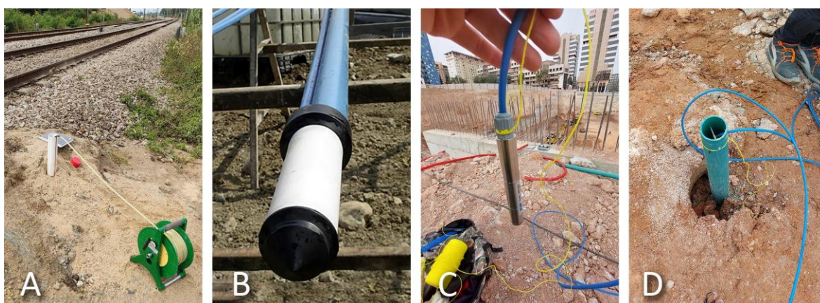
Figura 10 – (A) Piezómetro de tubo aberto com leitura manual através de sonda piezométrica; (B) Filtro poroso do piezómetro Casagrande; (C) Piezómetro de corda vibrante; (D) Instalação de piezómetros elétricos em sistema de aquisição automática de dados (fotografias do autor)
