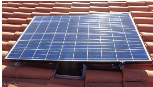
Figura 4 - Instalação de autoconsumo de 250 W (Alves, 2012)
