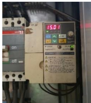
Figura 40- Variador de frequência para a tolva de alimentação
