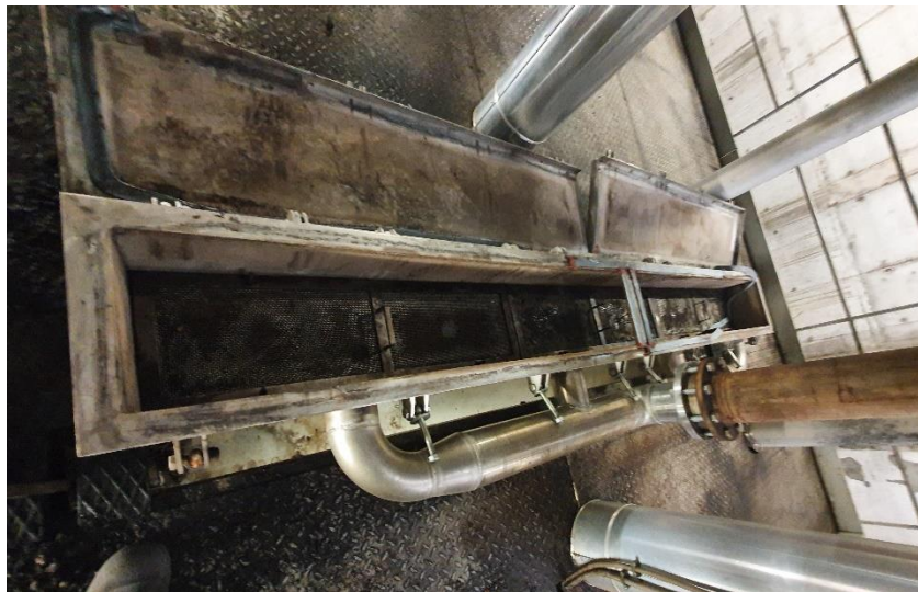
Figura 37- Redes superiores do Popcork após limpeza
