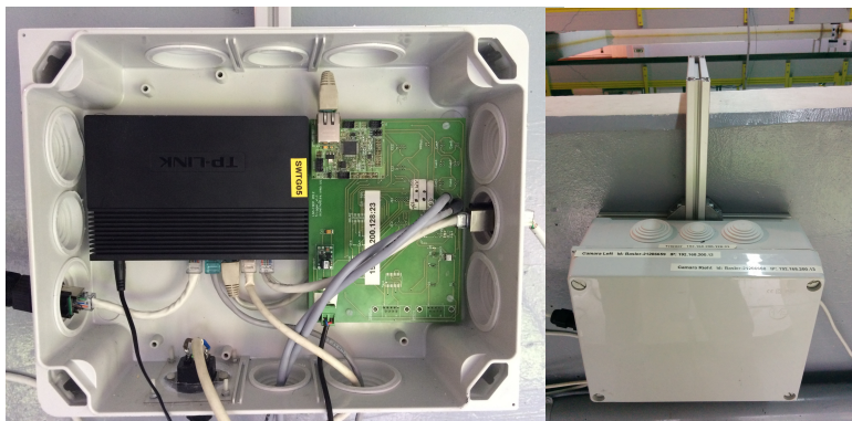
Figura 5.3: Esquerda - Sistema de disparo e alimentação das câmaras + switch GigE. Direita - Caixa estanque para instalação dos sistema de disparo e alimentação.
