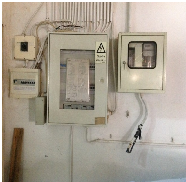
Figura 16 Quadro Elétrico Parcial
