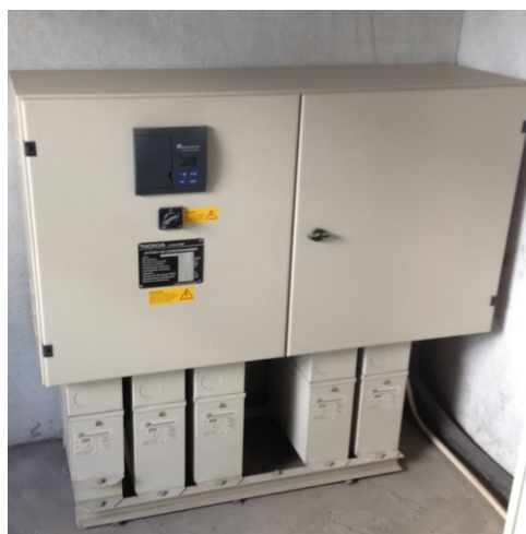
Figura 13 Bateria de Condensadores
