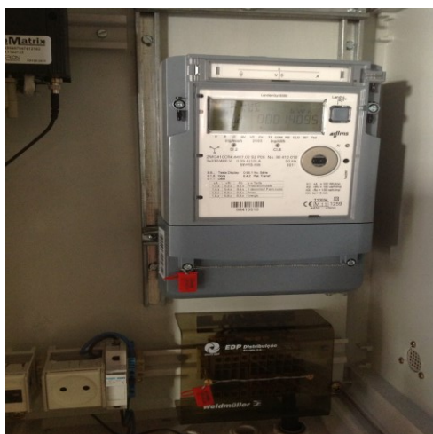
Figura 12 Contador de Energia
