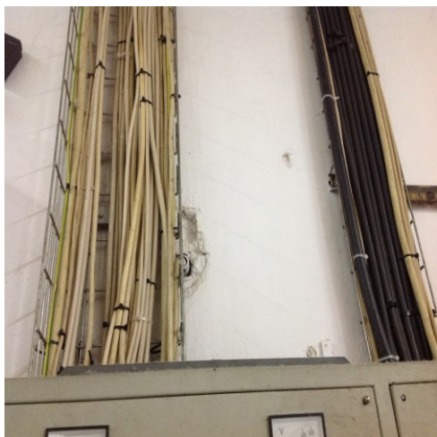
Figura 14 Cablagem de saída do QGE
