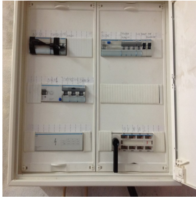
Figura 18 Quadro Elétrico dos Compressores
