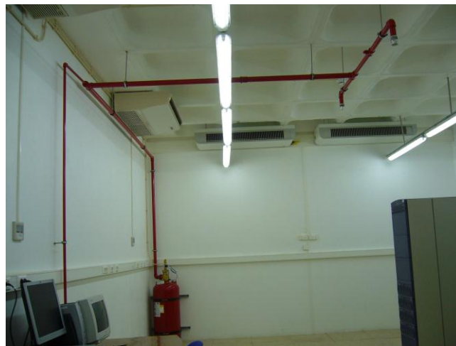
Figura 67 Sala do data-center / bastidores
