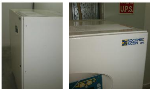
Figura 64 Unidade ininterrupta de energia
