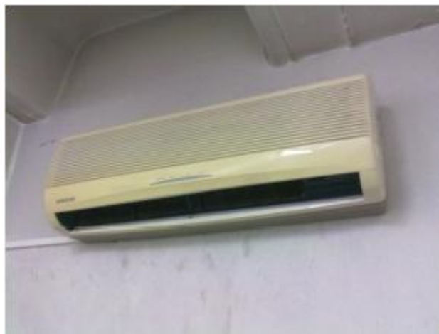
Figura 59 Exemplo dos splits existentes
