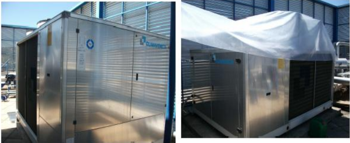
Figura 58 Chiller (esquerda) e Bomba de calor (direita)
