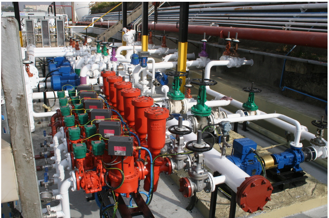
Bombas e coletor de compressão
