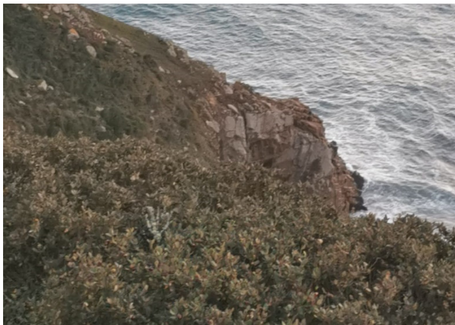
Figura 42 - Alteração parte final do talude.
