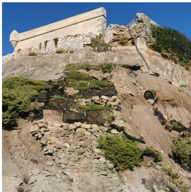
Figura 36 - Degradação do Forte e cimento projetado.
