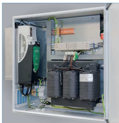
Figura 40 – Aspecto do armário de reinjecção Fonte: Control Techniques, 2012
