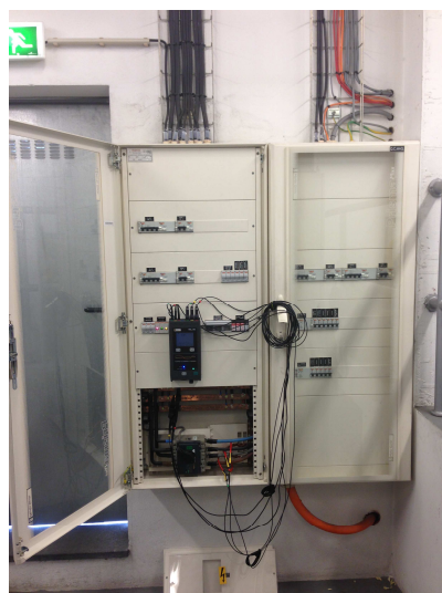
Figura 31: Medição no quadro de entrada da casa de máquinas
