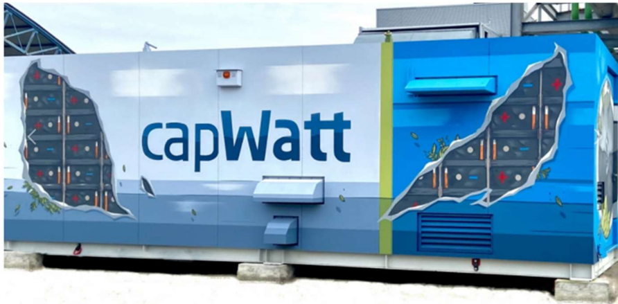
Figura 35 - Sistema de armazenamento de energia CapWatt
