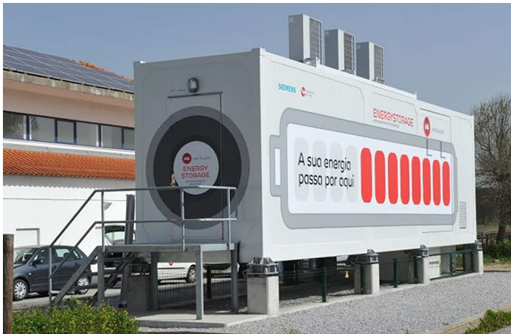
Figura 14 - Solução de armazenamento de energia da EDP, em Évora [42]
