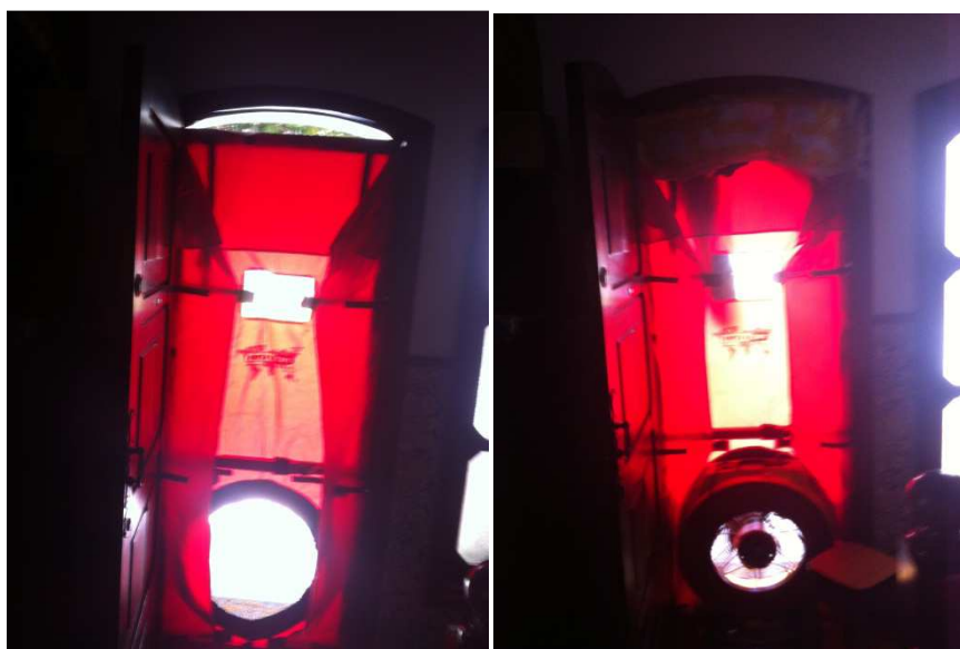
Figura 60 - esquerda: porta ventiladora antes de selar; direita: porta ventiladora totalmente selada
