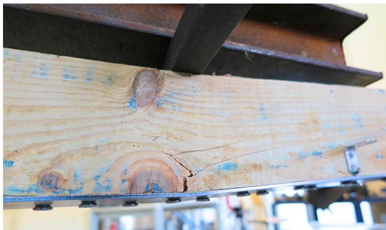
Figura 5.23 – Rotura da viga VCH1 (vista frontal).
