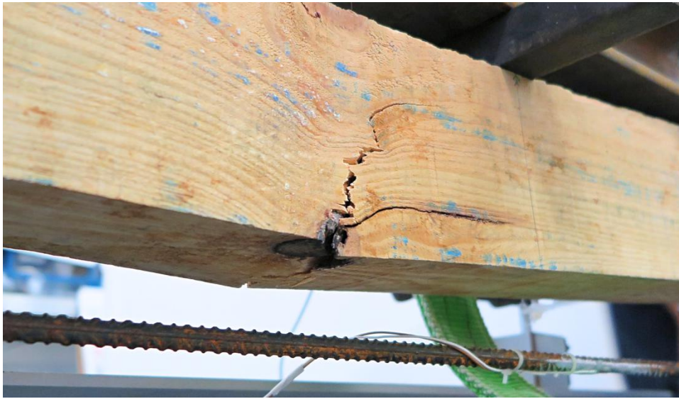
Figura 5.52 – Vista traseira da rotura da VV1.
