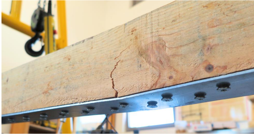
Figura 5.24 – Rotura da viga VCH1 (vista traseira).
