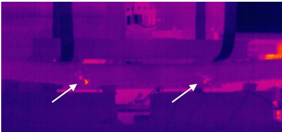
Figura 5.26 – Rotura simultânea em dois pontos captada pela câmera termográfica.
