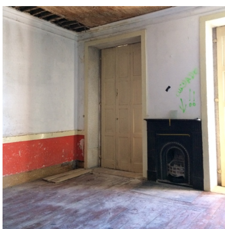
Figura 6.3 – Estado do pavimento da divisão Sul, lado nascente, piso 2.
