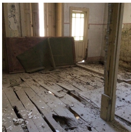
Figura 2.15 – Pavimento de madeira degradado.
