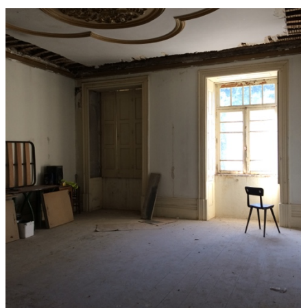
Figura 6.4 – Estado do pavimento da divisão Sul, lado nascente, piso 1.
