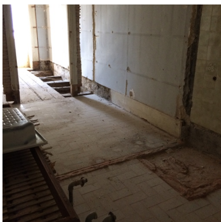
Figura 6.1 – Estado do pavimento da divisão Sul, lado poente, piso 2.
