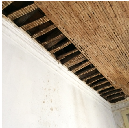
Figura 2.16 – Teto sem revestimento.
