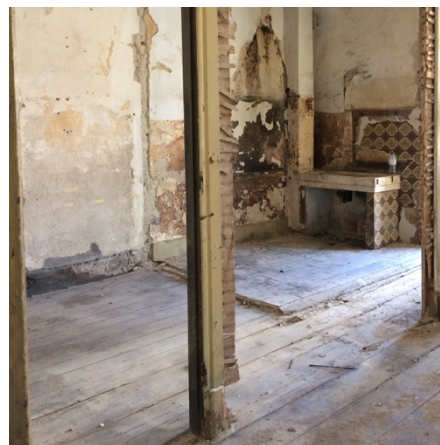
Figura 6.6 – Estado do pavimento da divisão Norte, lado poente, piso 1.
