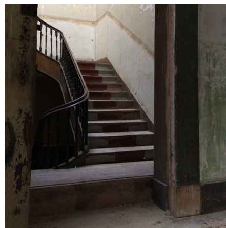
Figura 6.10 – Estado do pavimento das circulações horizontais comuns, piso 1.
