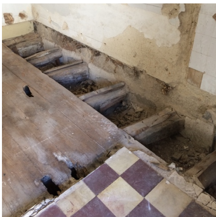
Figura 6.5 – Estado do pavimento da divisão Norte, lado poente, piso 1.
