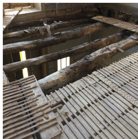
Figura 6.8 – Estado do pavimento da divisão Norte, do lado nascente, piso 2.
