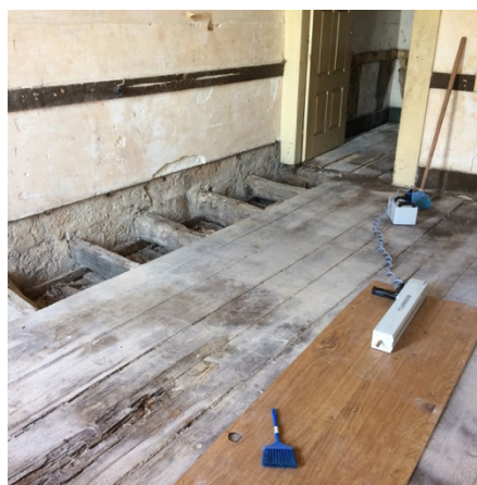
Figura 6.2 – Estado do pavimento da divisão Sul, lado poente, piso 2.
