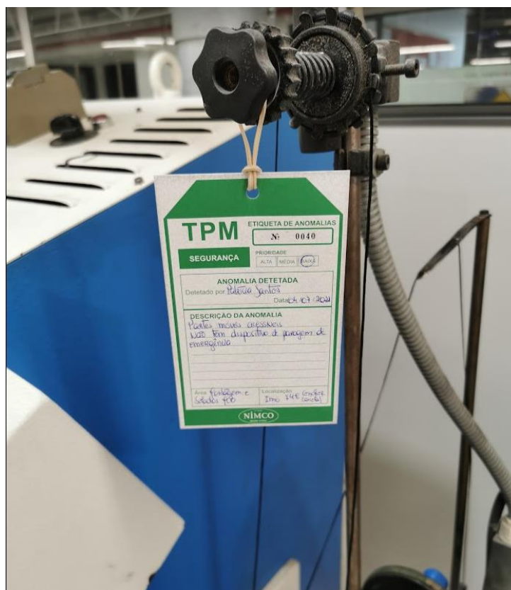
Figura 15 - Etiqueta TPM de Segurança aberta por uma trabalhadora devido à falta de mecanismo para paragem de emergência.
