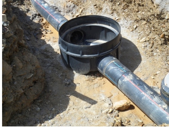
Figura B.9 – Aspetto final da soldadura (exemplo ligação de tubagem a caixa de visita)
