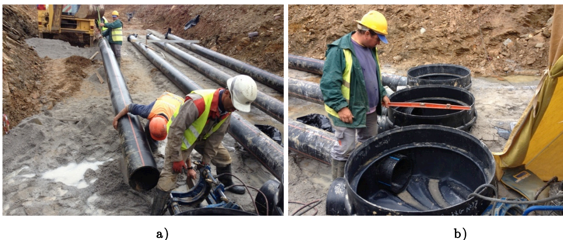
Figura B.4 - a) realinhamento dos elementos recorrendo a escavadora; b) verificação do nivelamento de caixa de visita, feito de forma a garantir a pendente necessária.
