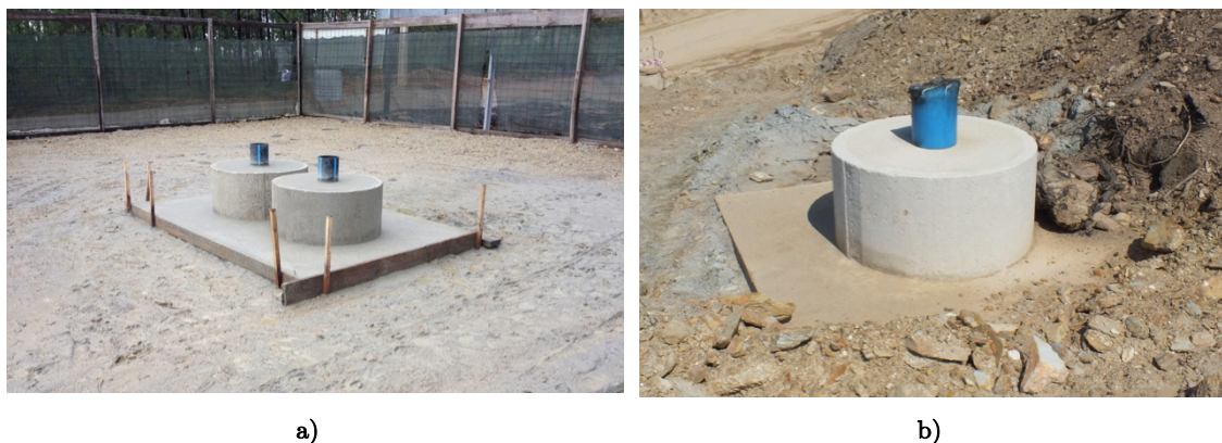
Figura C.10 – Piezómetros: a) piezómetro duplo após realização do maciço de encabeçamento; b) piezómetro simples após realização do maciço de encab
