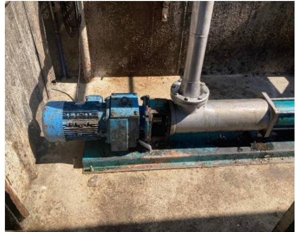
Figura 4.11. Bomba do foço
