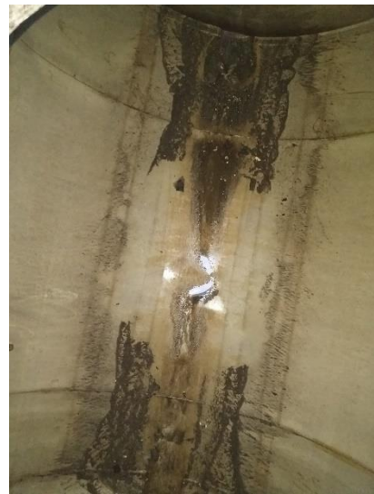
Figura 4.13. Cisterna sem restos alocados no fundo
