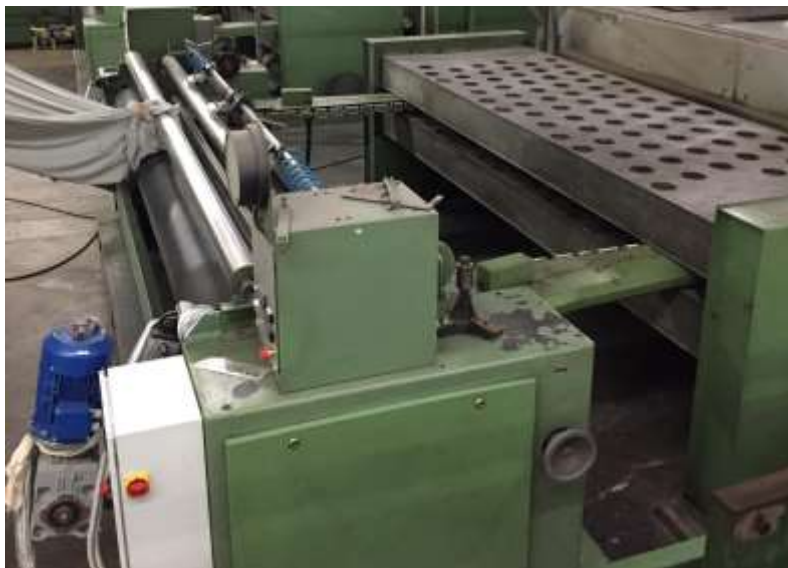
Figura 7 – Râmola 4: zona de saída do tecido da estufa, com passagem do transporte cadeado para rolo
