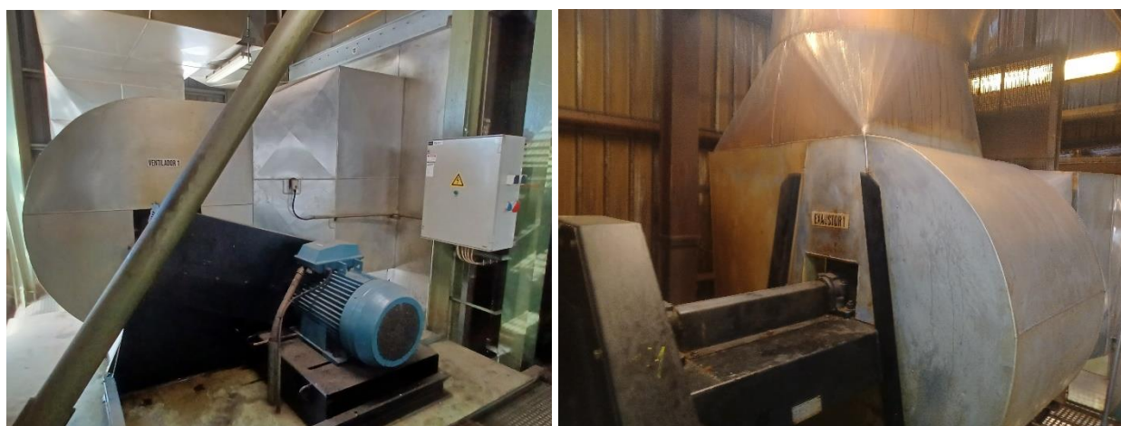
Figura 3. 3 Ventiladores e exaustor da Estufa 1
