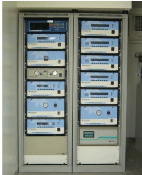
Figura 1.2 Exemplo da instrumentação associada às medições fixas existente no interior de estação fixas de medição da poluição do ar [5].
