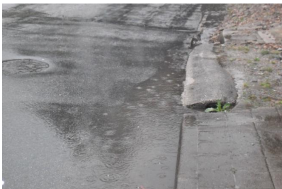
Figura 139 - Acumulação de Água no Pavimento
