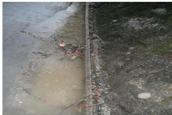
Figura 153 - Incapacidade da Valeta Drenar
