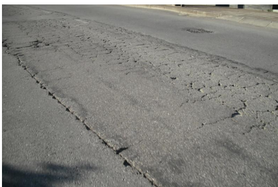
Figura 121 - Fendas Longitudinais e Rodeiras
