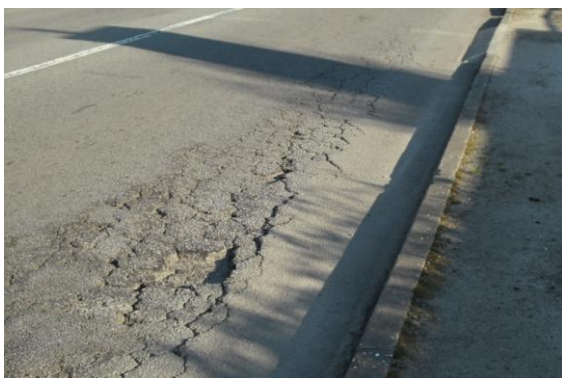
Figura 129 - Desagregação Superficial e Ninhos
