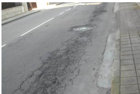
Figura 131 - Desagregação Superficial e Pele de Crocodilo
