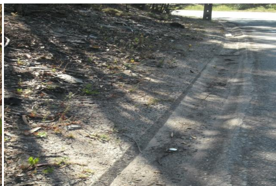
Figura 148 - Valeta Obstruída com Lixo
