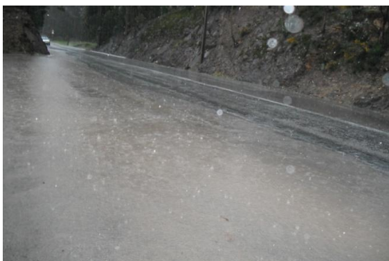
Figura 141 - Acumulação de Água no Pavimento
