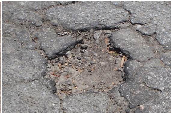
Figura 29 – Desagregação Superficial (Jacob, 2013)
