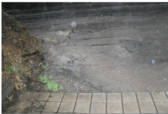
Figura 140 - Acumulação de Água no Pavimento
