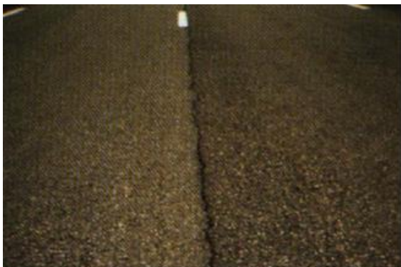
Figura 20 – Fenda Longitudinal no Eixo da Faixa (Souza, 2004)
