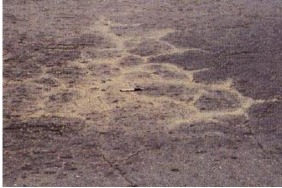
Figura 27 – Desprendimento de Agregados (Souza, 2004)
