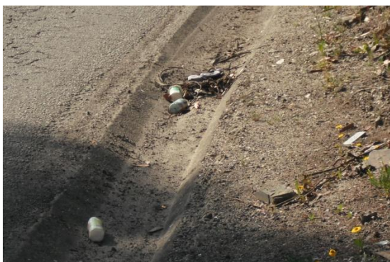
Figura 147 - Valeta Obstruída com Lixo
