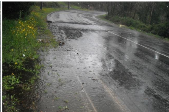
Figura 152 - Incapacidade da Valeta Drenar
