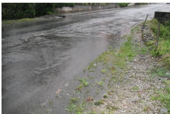
Figura 142 - Acumulação de Água no Pavimento
