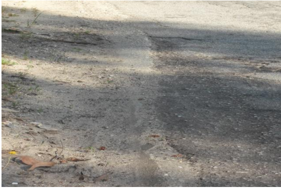
Figura 149 - Valeta Obstruída com Lixo
