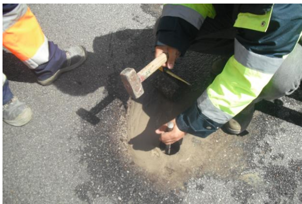
Figura 160 – Fragmentação do Topo da Sub-base
