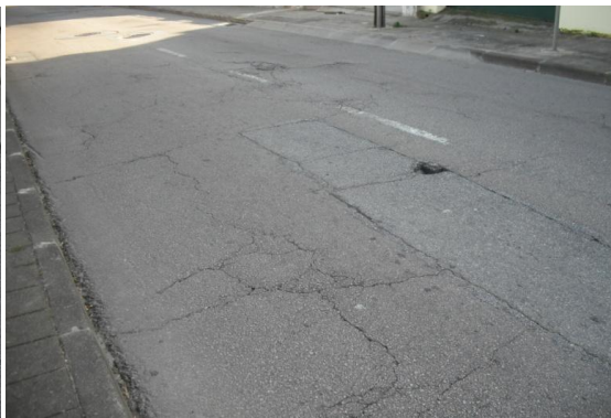
Figura 43 - Fendas Longitudinais e Ninho
