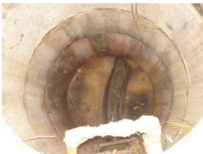
Figura 4.12 - Exemplo de uma câmara de visita com problemas nas juntas.
