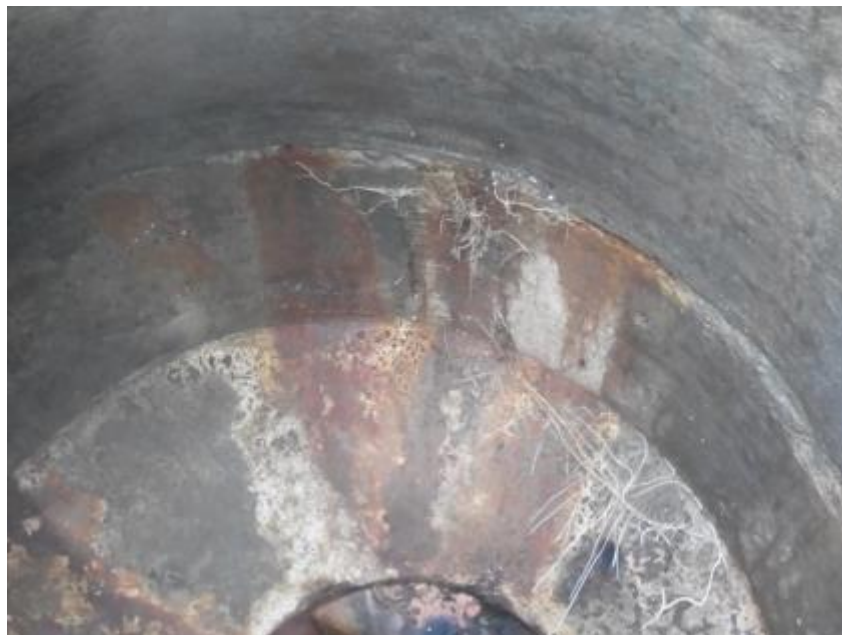
Figura 4.16 - Exemplo de uma câmara de visita com raízes nas juntas.
