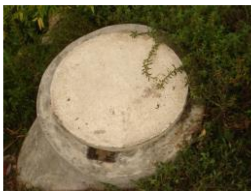
Figura 4.5 - Exemplo de uma câmara de visita com tampa em betão.
