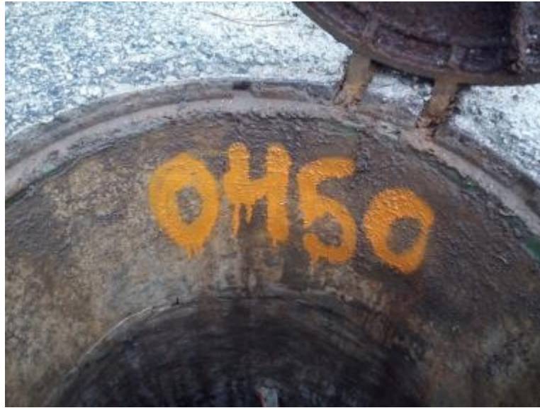
Figura 4.9 - Exemplo de uma câmara de visita com o revestimento fissurado.
