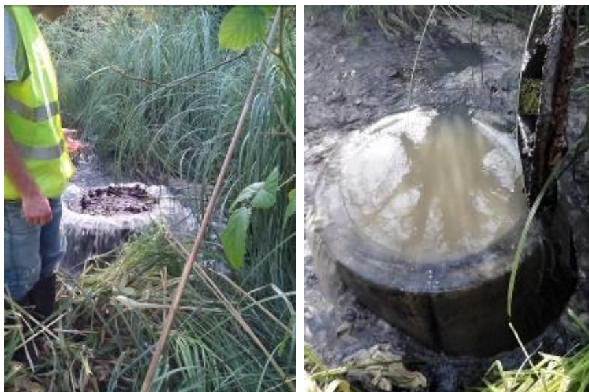
Figura 4.1 – Transbordamento de uma câmara de visita.
