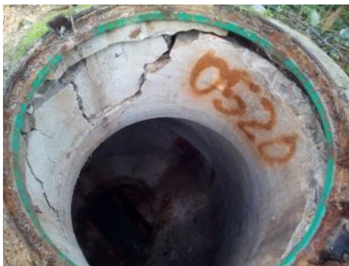
Figura 4.11 - Exemplo de uma câmara de visita com o betão fissurado.
