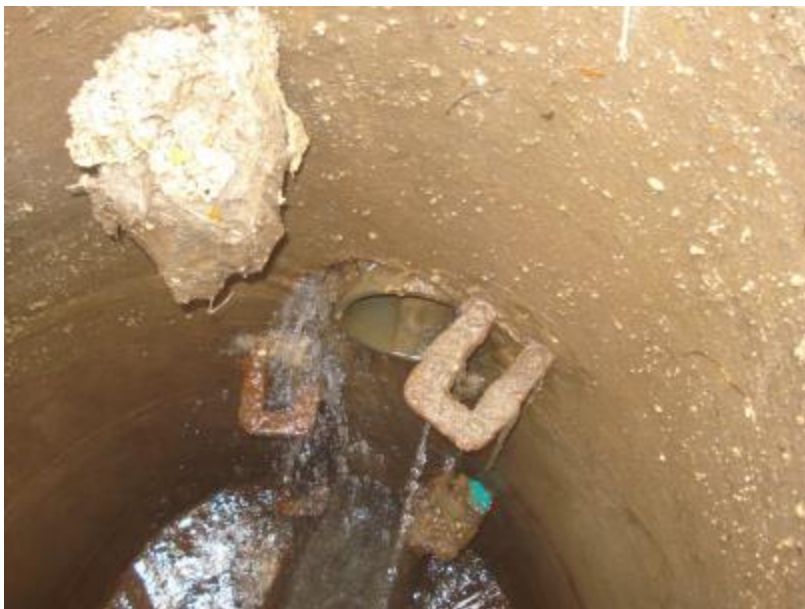
Figura 4.18 - Exemplo de uma câmara de visita com infiltrações pela fissura no betão.
