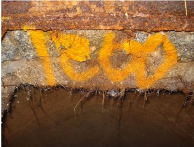
Figura 4.19 - Exemplo de uma câmara de visita com infiltrações pelas raízes.
